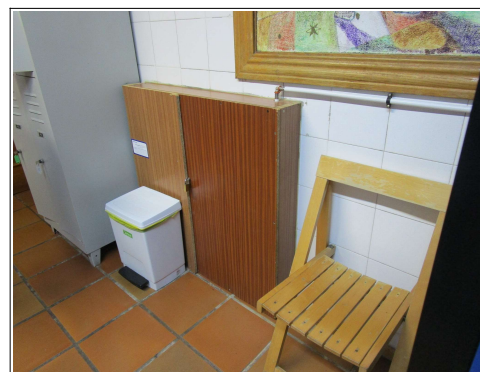
Cajón de acometidas de agua en el dormitorio
