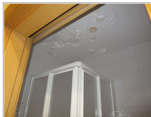
Humedades en el falso techo del aseo
