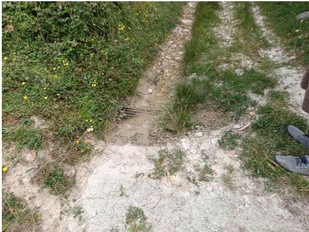
Imagen 32. Rejilla canal aterrada frente a vivienda n°9
