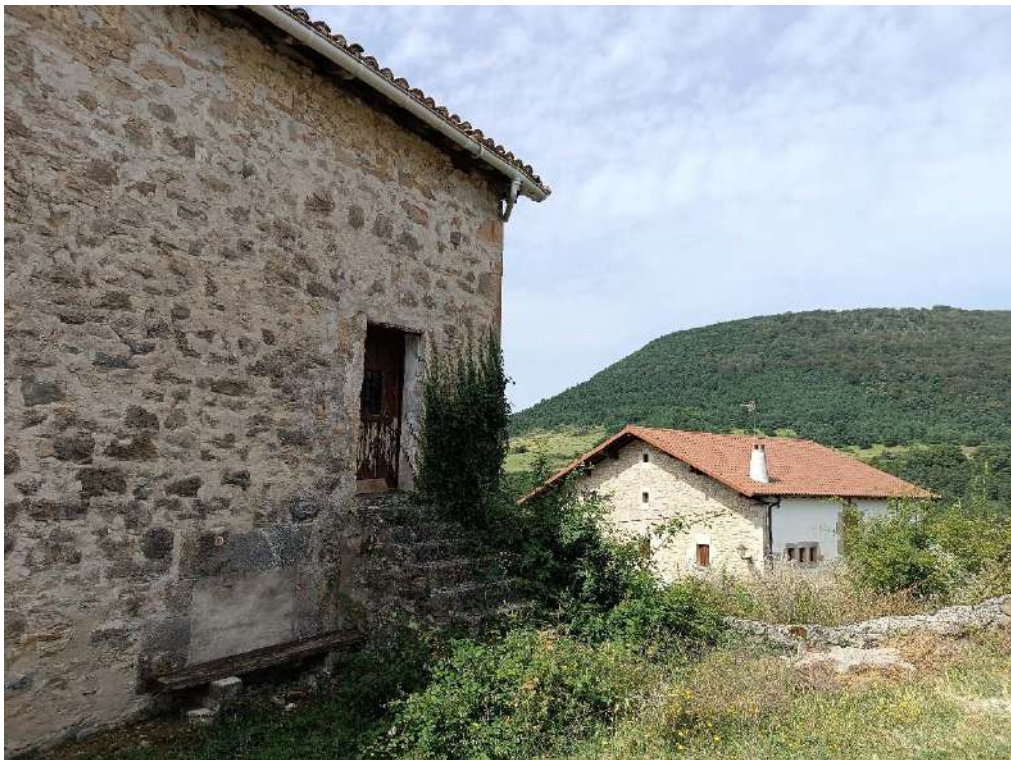
Imagen 25. C/ la Virgen nº9. Acceso posterior y bajante de pluviales
