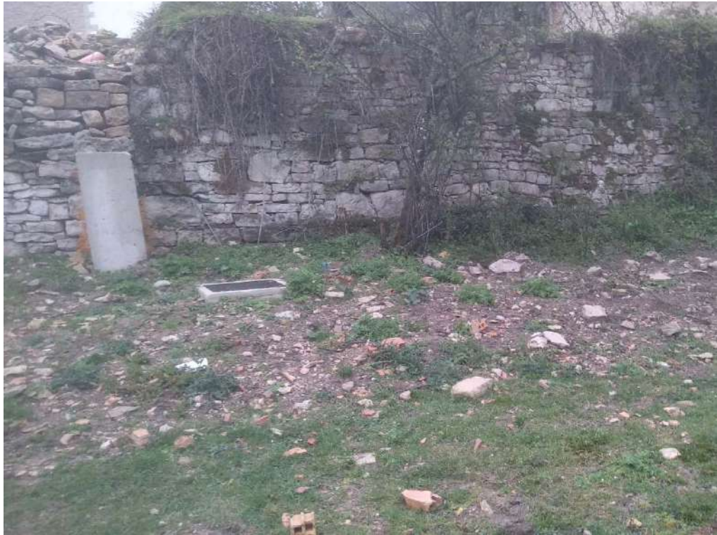
Imagen 35. Resalto de la red de fecales existente hacia la fosa séptica
