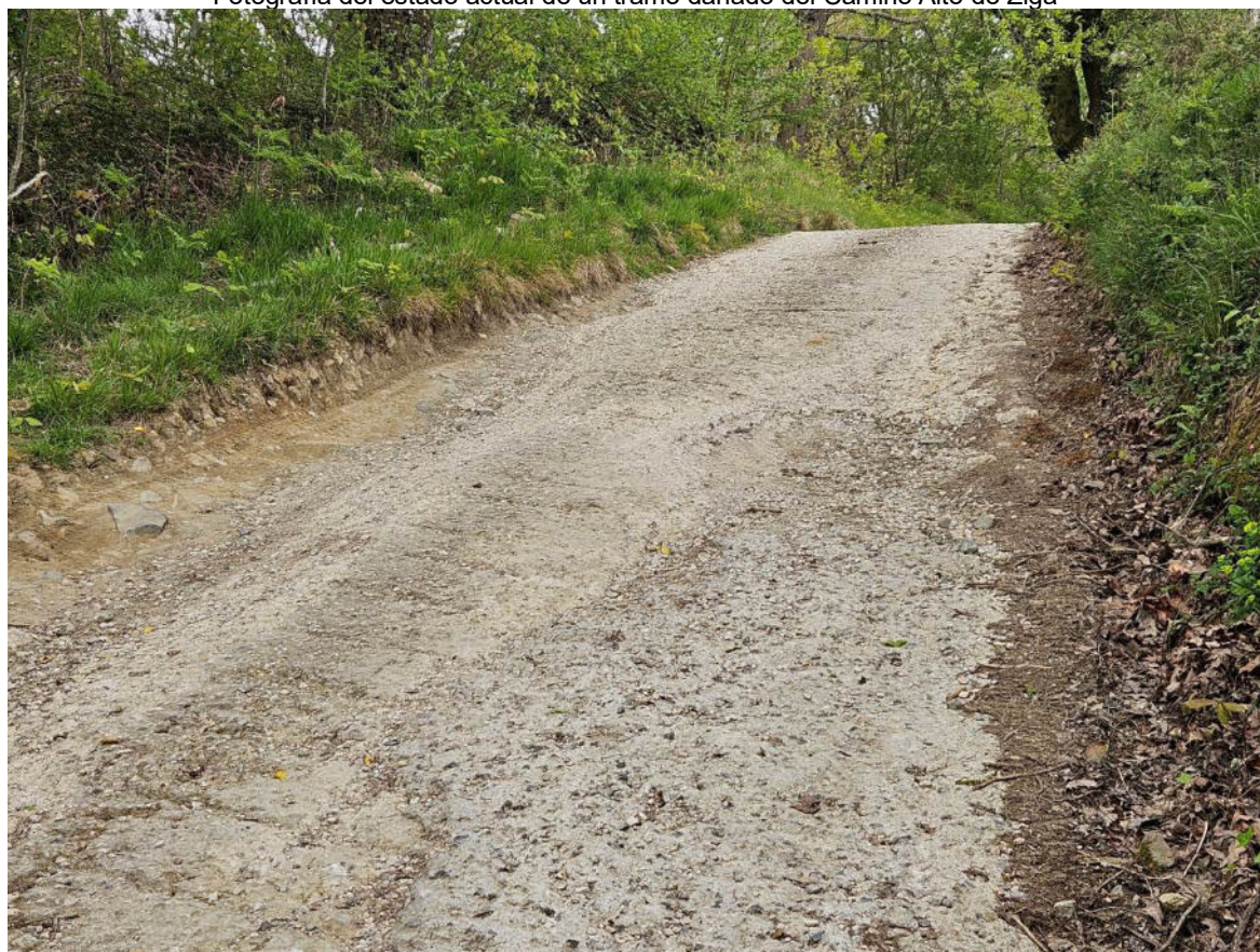
Fotografía del estado actual de otro tramo dañado del Camino Alto de Ziga
