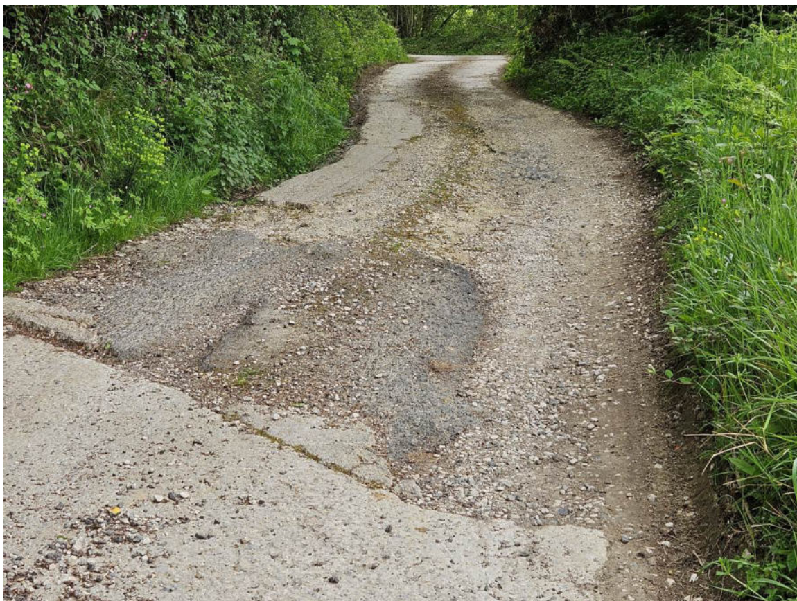
Fotografía del estado actual de un tramo dañado del Camino Alto de Ziga
