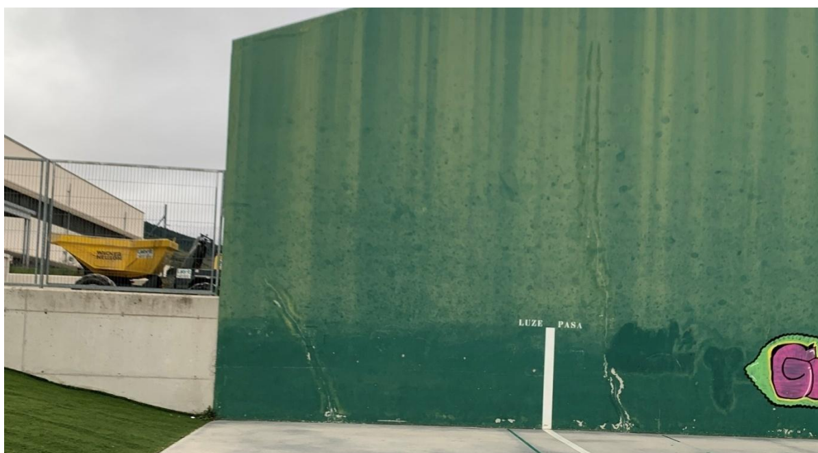
Detalle de la parte posterior de la pared lateral. Se observan dos fisuras, consecuencia de un asiento de la cimentación en dicha zona. También se observa el murete que contiene la calle posterior, cuya rasante se eleva unos 1,50 m
