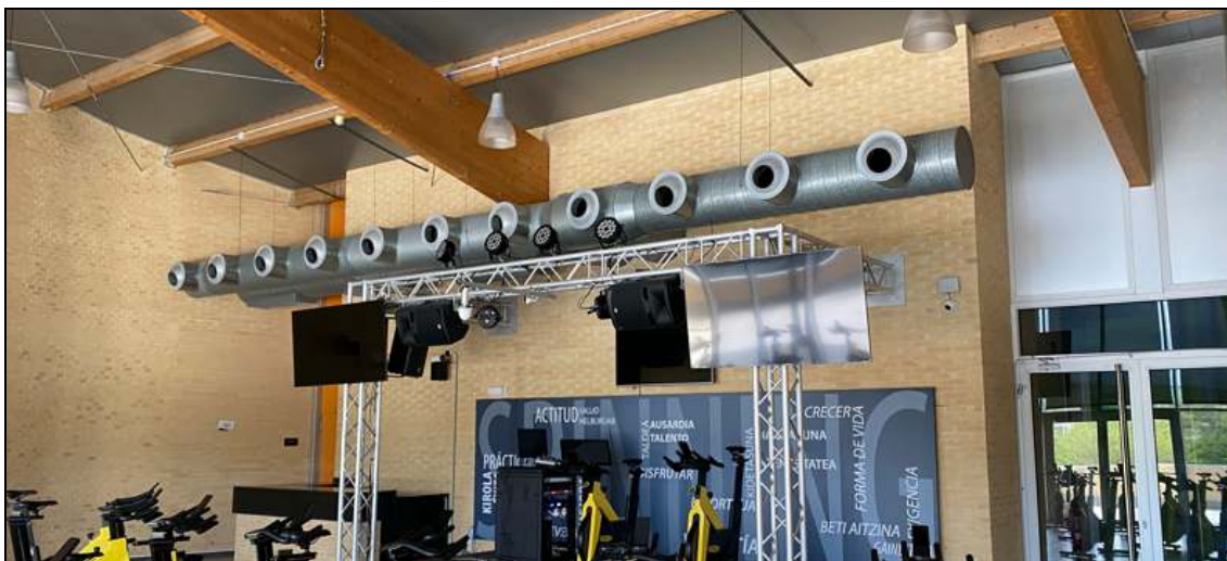
Imagen. Fotografía de la climatización del recinto
