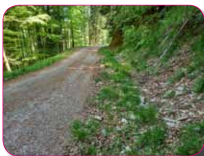
Errekaidorra, cuneta casi inexistente
