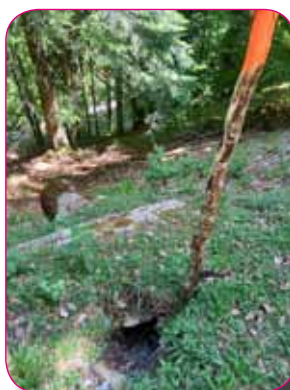
Errekaidorra, paso de agua desencajado (punto 2)
