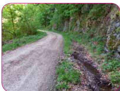
Errekaidorra, depósitos en cuneta
