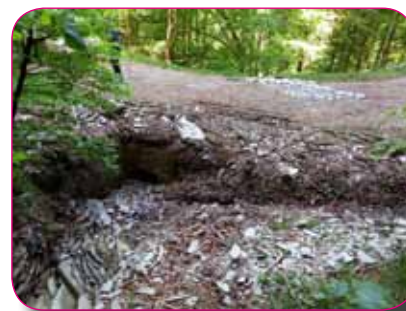
Errekaidorra, paso de agua con frecuentes desbordamientos (punto 3)
