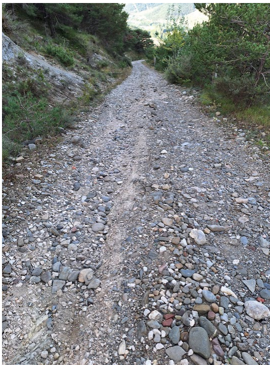
Imagen 4: Camino del repetidor, Irotz. Estado actual.-
