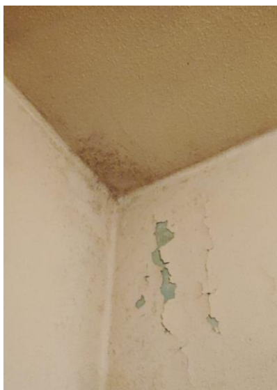
Humedad en las viviendas.
