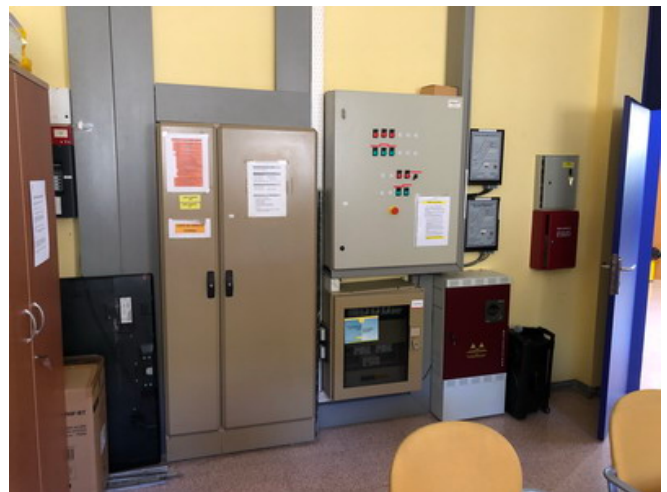
Foto 6: Cuadros de instalaciones en administración
