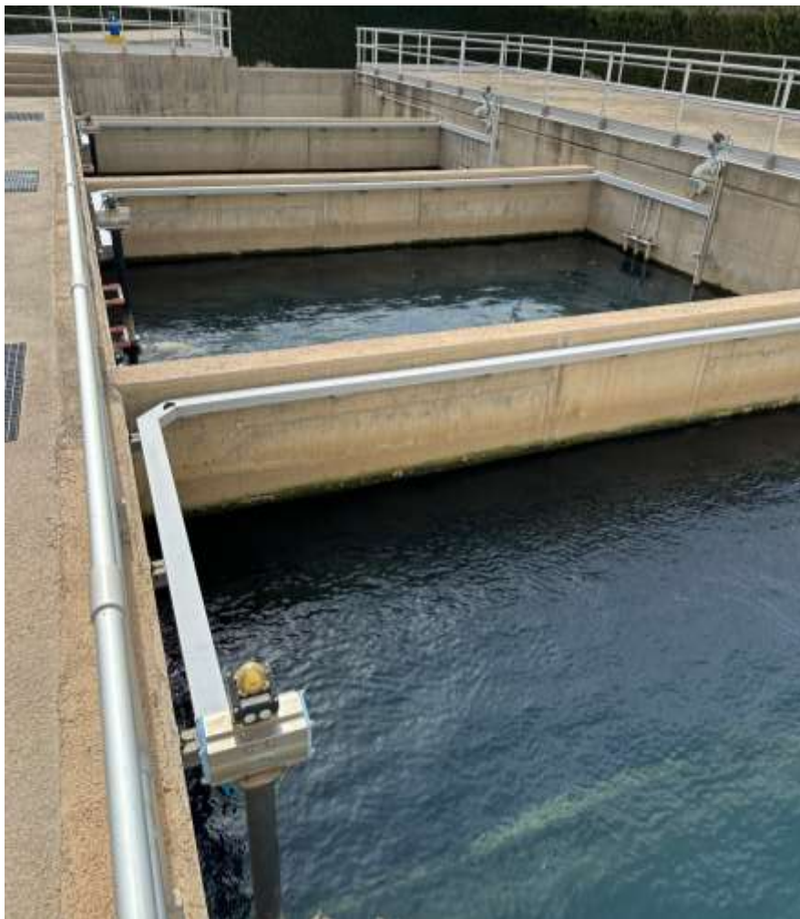
Vista de los tres filtros
