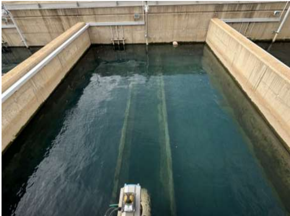
Detalle de uno de los filtros de doble lecho
