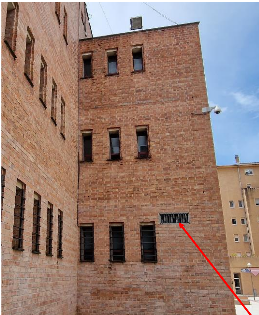
Rejilla exterior para la extracción de aire de los vestuarios
