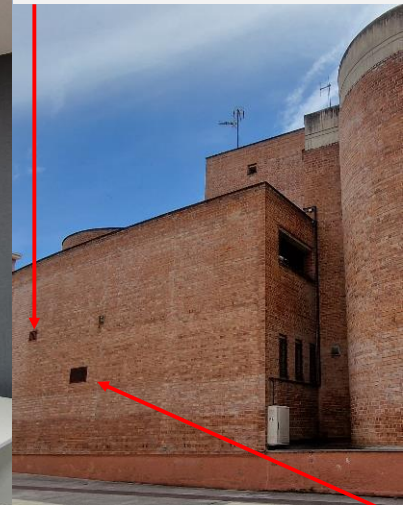
Rejilla exterior para la ventilación del auditorio
