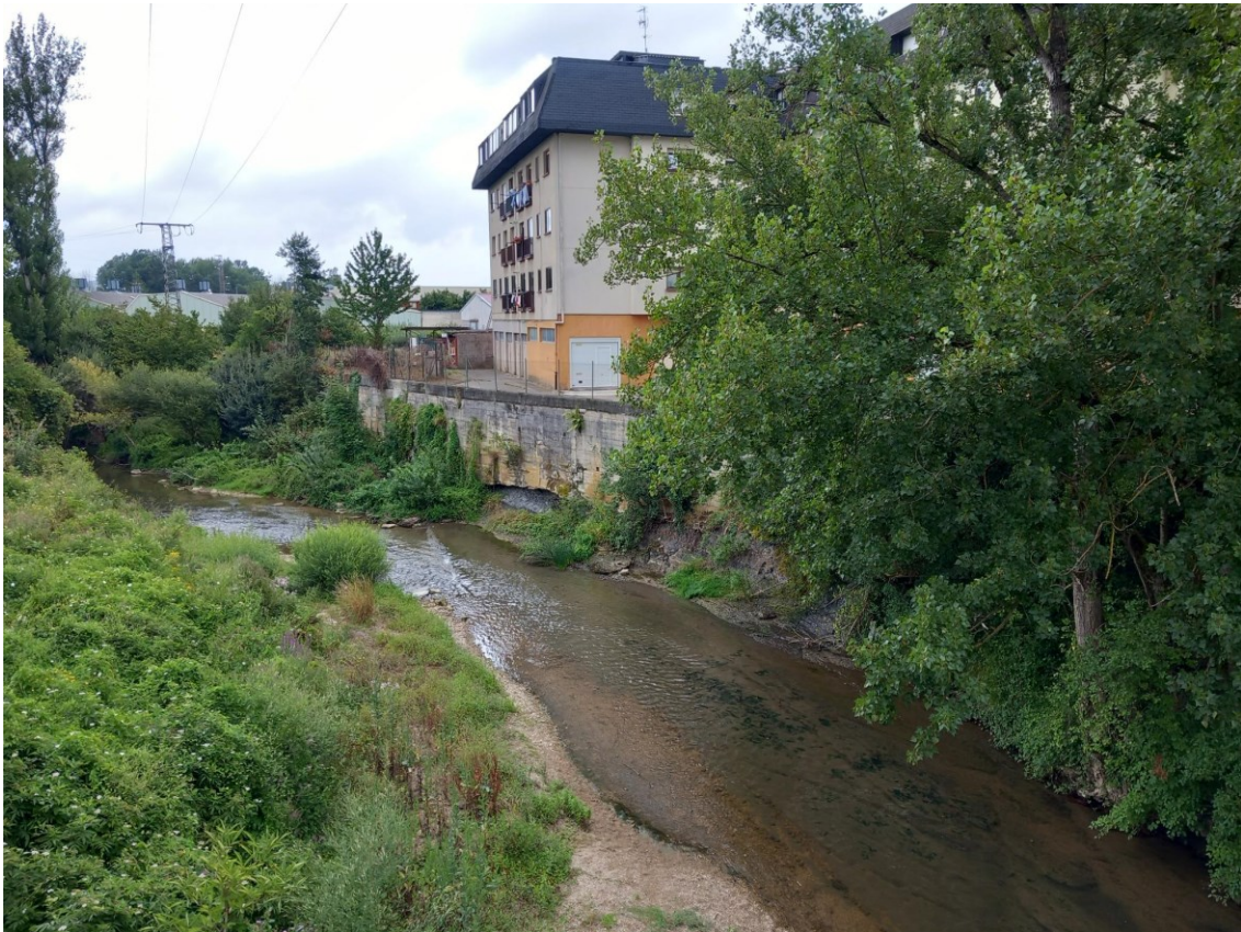
Zona afectada por la fuerza del río, con el derrumbe parcial del muro de hormigón existente.
