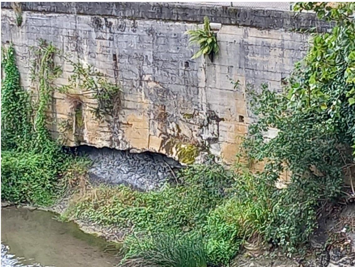
Detalle de la zona afectada, con arrastre de la tufa de base de la cimentación.
