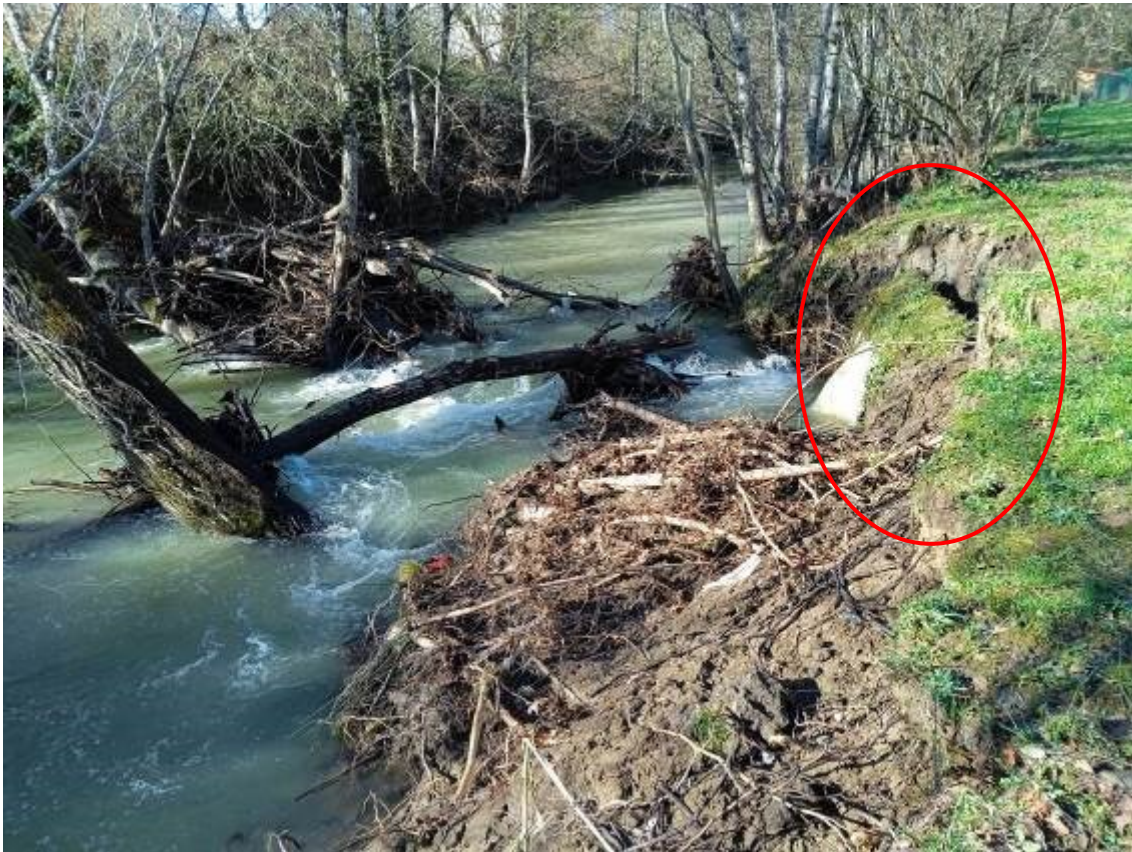
Cauce afectado por la erosión, que ha provocado el desplazamiento del terreno (se señala en rojo).
