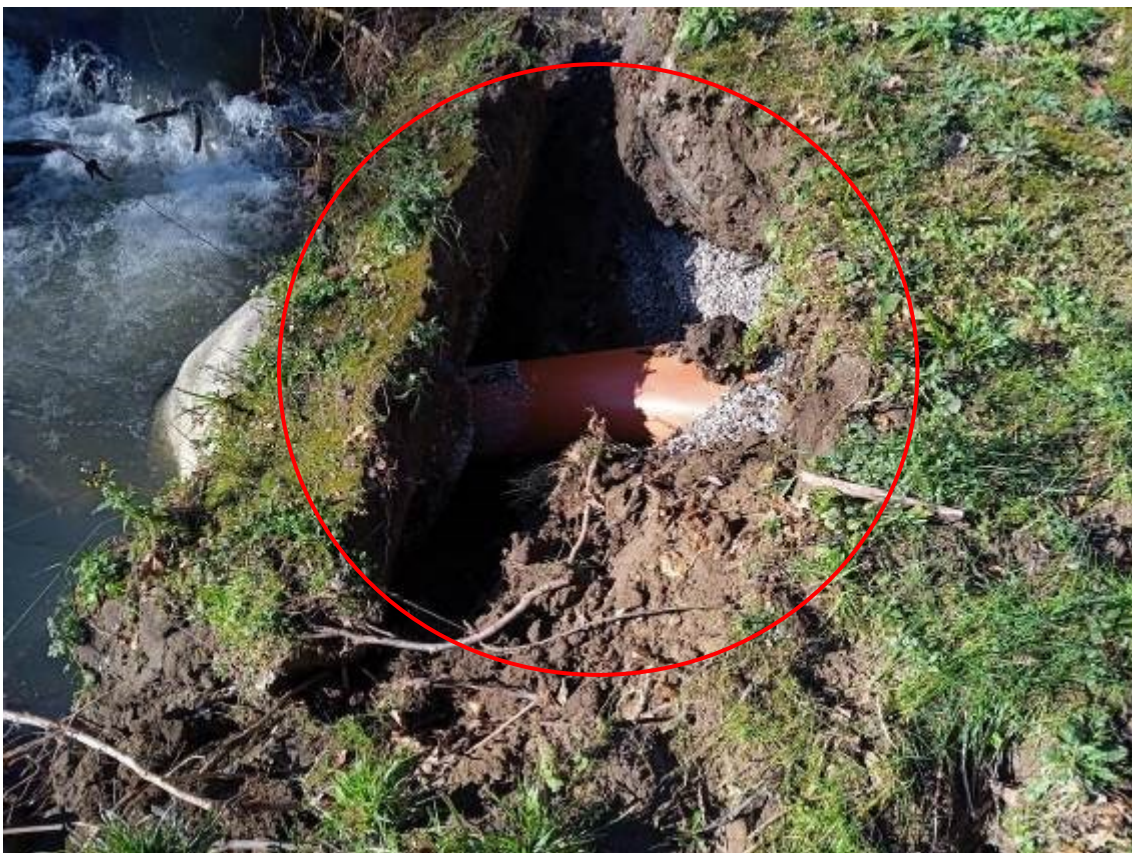
Zona del desprendimiento del terreno como consecuencia de la erosión, afectando al emisario.
