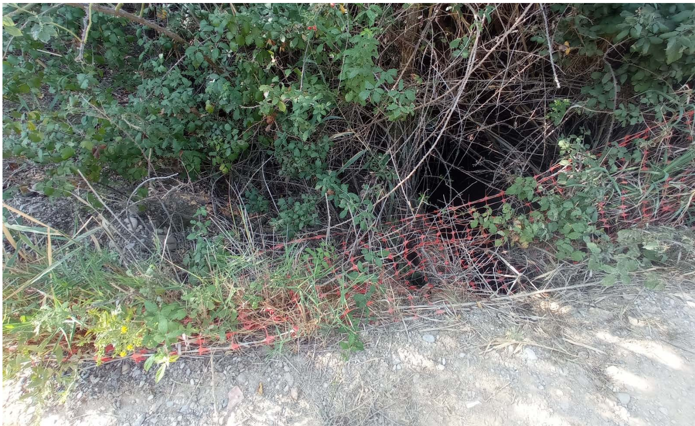
Detalle falta de visibilidad. Protección hueco.
