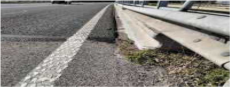
Foto_Sistema de drenaje_1.png Foto 2 canalillo arcen izquierdo
