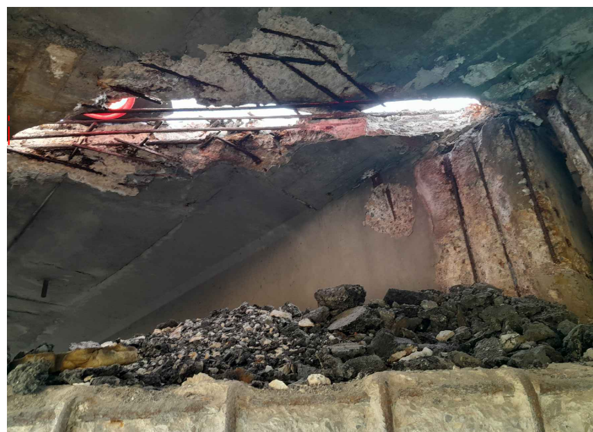
ESTADO ACTUAL TABLERO EN ZONA JUNTAS
