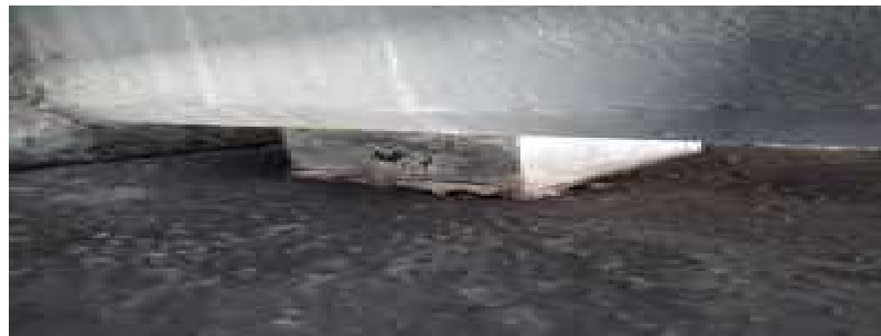
Foto_Estribos_4.png Foto 14 apoyo viga 2 estribo 1 deteriorado
