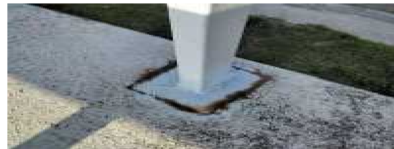
Foto_Contención_1.png Foto 3 base barandilla oxidada
