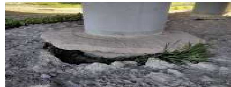
Foto_Pilas_4.png Foto 23 Erosión en Pila cargadero 2
