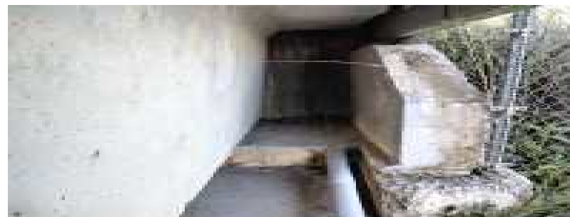
Foto_Estribos_4.png Foto 11 Estribo 1
