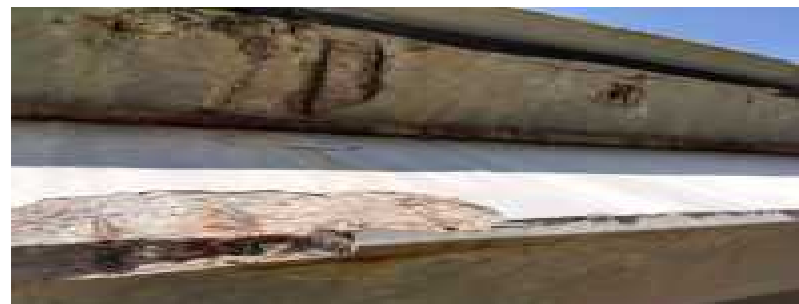
Foto_Vigas y riostras_6.png Foto 30 ala de viga 6
