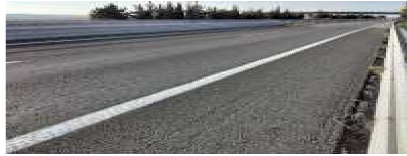
Foto_Estado del pavimento_1.png Foto 4 Mal estado del pavimento
