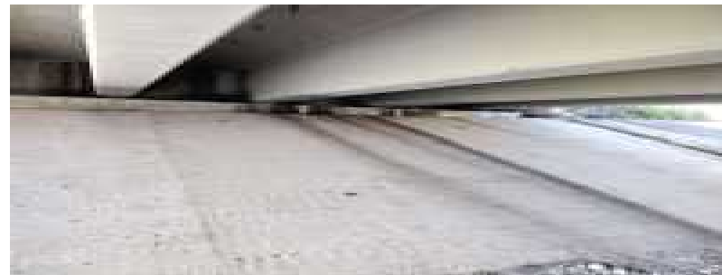
Foto_Estribos_1.png Foto 8 Estribo 1
