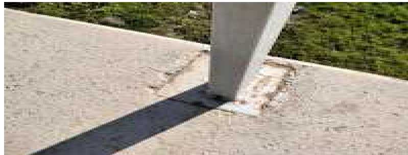
Foto_Contención_1.png Foto 3 base de barandilla oxidada
