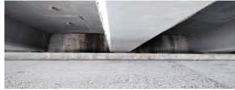
Foto_Estribos_7.png Foto 18 Estribo 2
