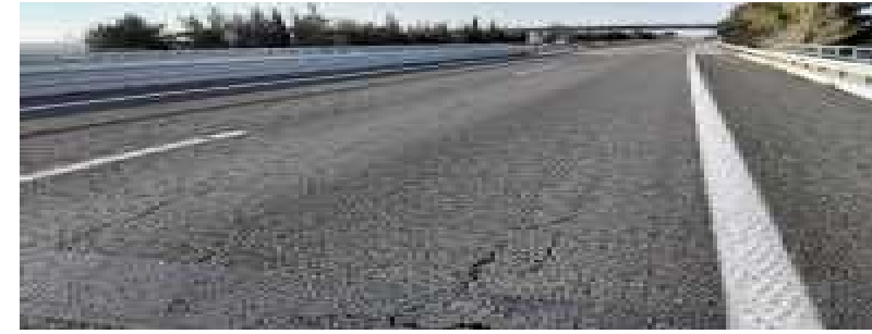
Foto_Estado del pavimento_2.png Foto 5 carril derecho
