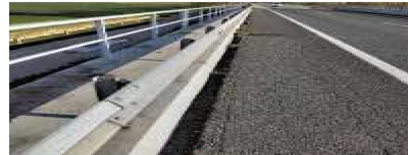
Foto_Sistema de drenaje_1.png Foto 10 canalillo derecho sucio
