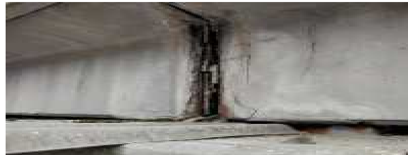
Foto_Vigas y riostras_7.png Foto 27 vigas 6 sobre cargado 2
