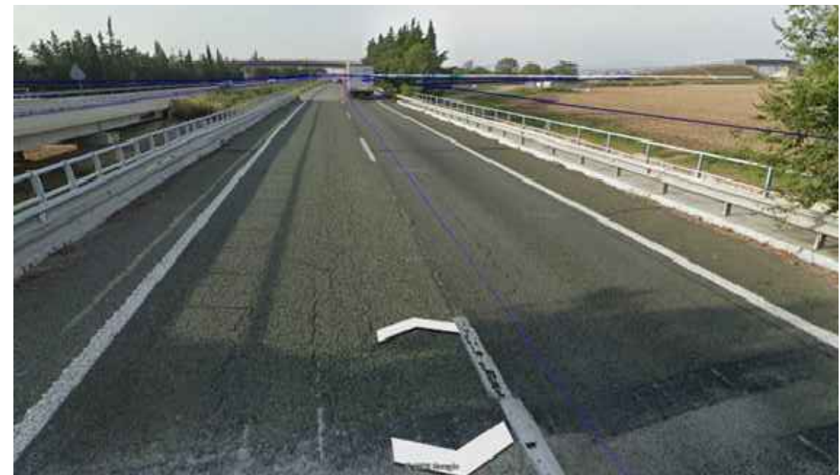
ESTADO ACTUAL DE LA PARTE SUPERIOR DEL TABLERO
