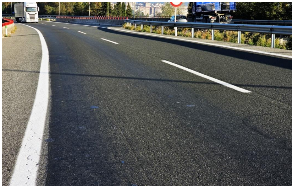
Foto: exudaciones en rodada del pk 83+500
