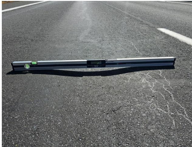
Foto roderas y fisuración del pk 22+000
