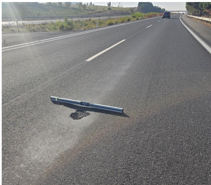
Foto roderas con pérdida de material pk 18+200
