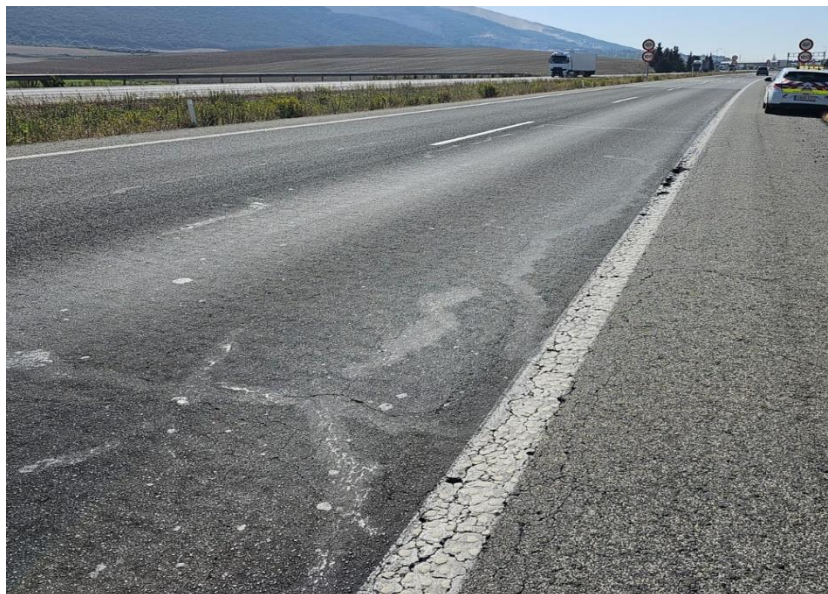
Foto pk 78+000 exudación en rodadas, fisuración y pérdida material c derecho
