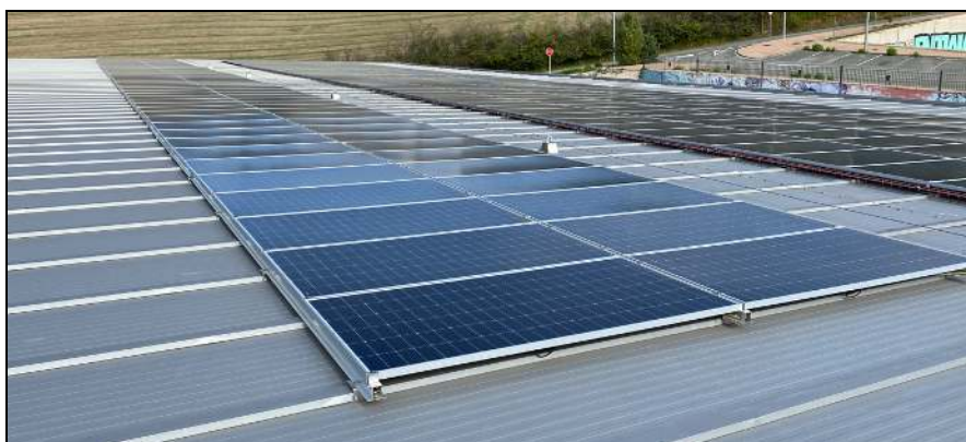
Imagen. Planta fotovoltaica sobre la cubierta de la pista de hielo
