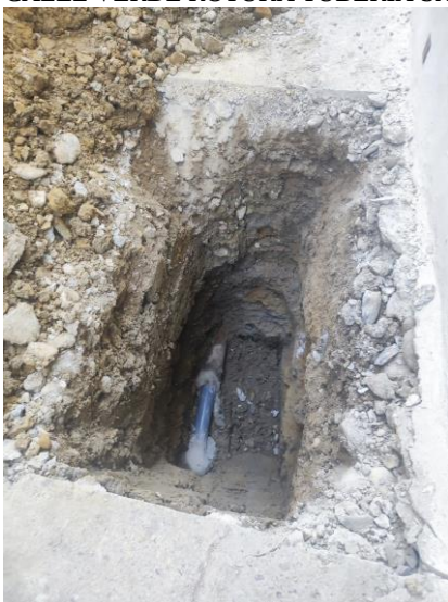
CALLE VERDE ROTURA TUBERIA SANEAMIENTO. REPARACION CON EMPALME DE TUBO. 30/9/2023
