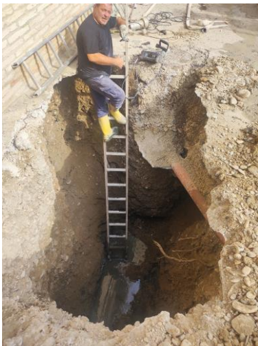
REPARACION DE DESPERFECTO Y FUGA EN COLECTOR DE SANEAMIENTO EN CALLE VERDE EN ENTRONQUE DE POZO DE REGISTRO
