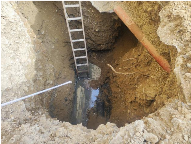
REPARACION DE DESPERFECTO Y FUGA EN COLECTOR DE SANEAMIENTO EN CALLE VERDE EN ENTRONQUE DE POZO DE REGISTRO
