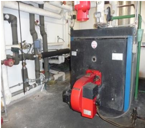
Edificio vestuarios: Calefacción – ACS
