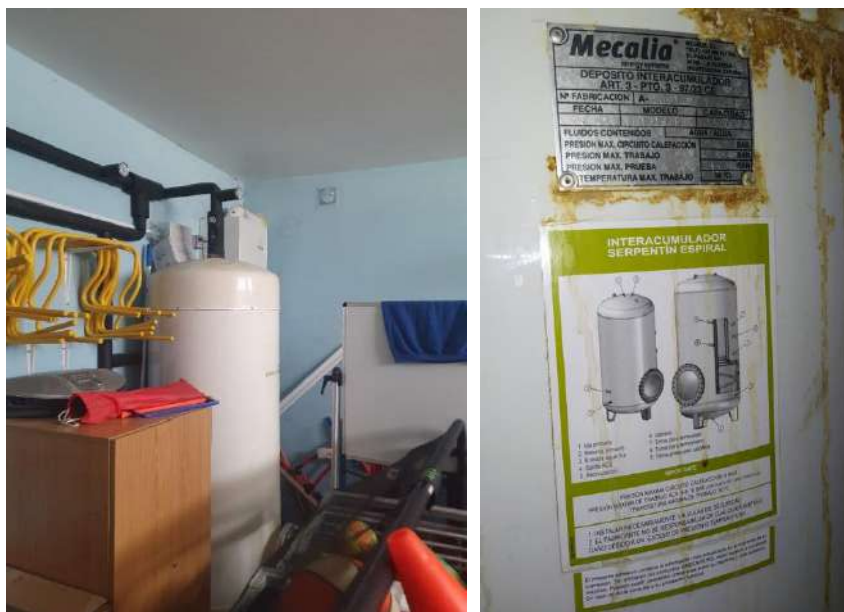
Fotografía 12: Productor de ACS ubicado en Despacho / Almacén
