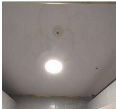
Fotografía 18: Humedades en techo
