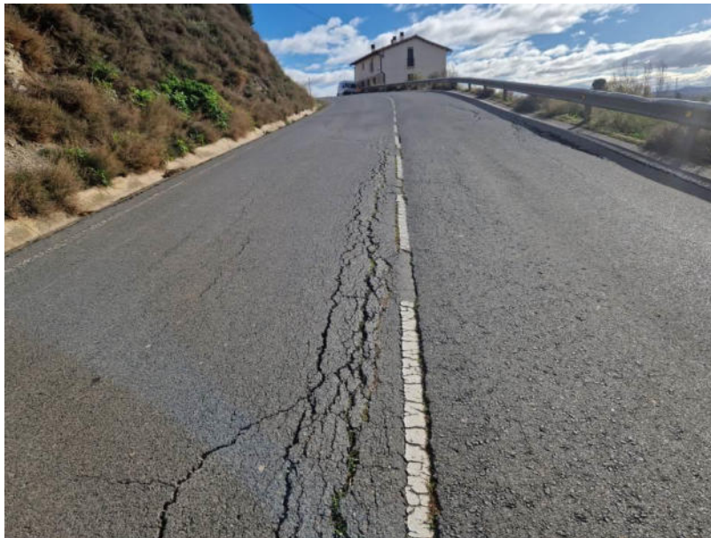
Fisuras en el pavimento
