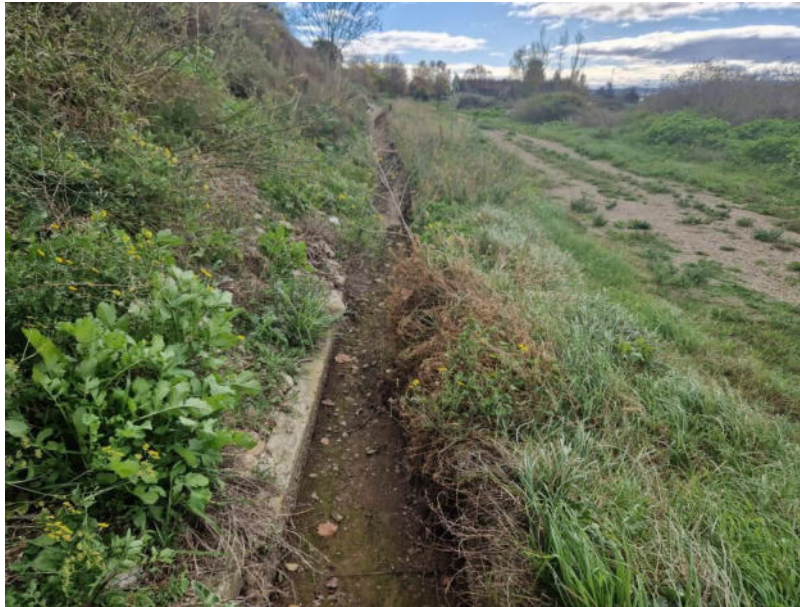
Tramo de acequia a reparar
