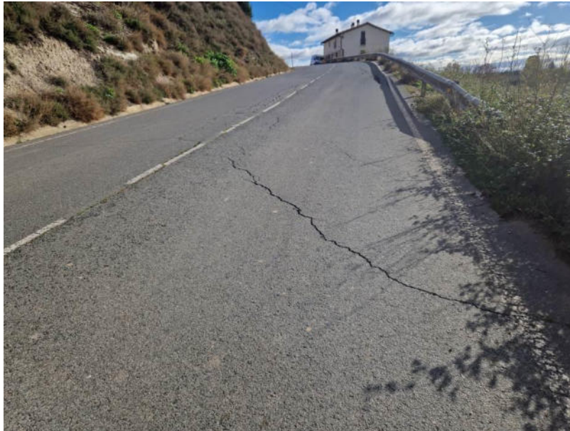
Fisuras en el pavimento
