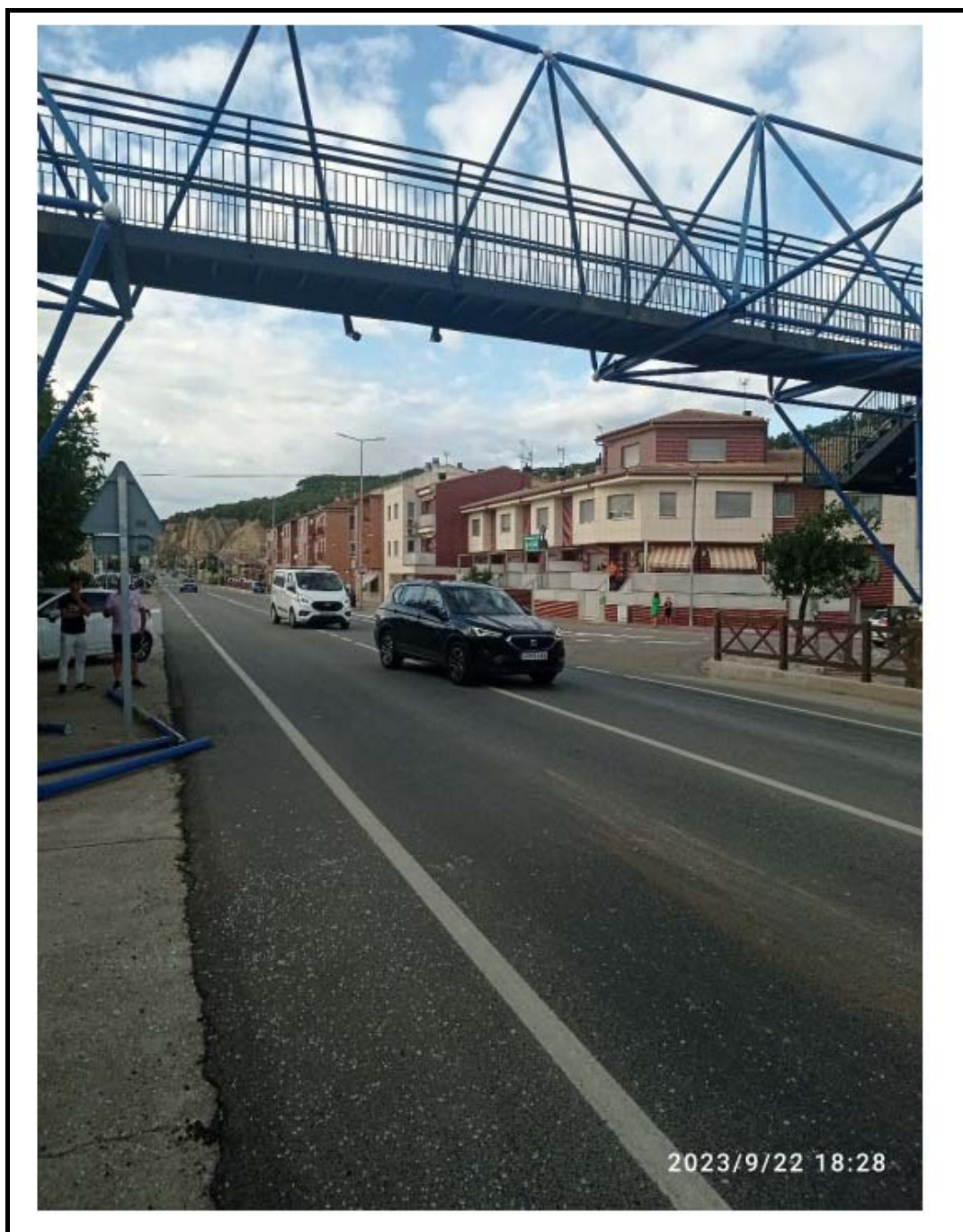
DETALLE PARTE INFERIOR DE CERCHA DESPRENDIDA
