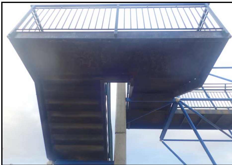
DETALLE REPISAS OXIDADAS
