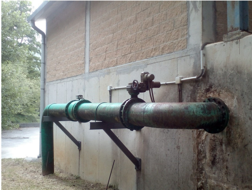
Imagen 6: Tubería de entrada.
