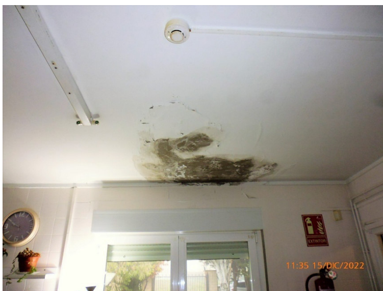
Goteras en zona de cocina
