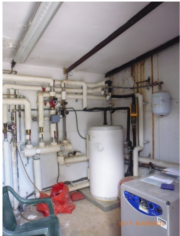
Sala de calderas actual
