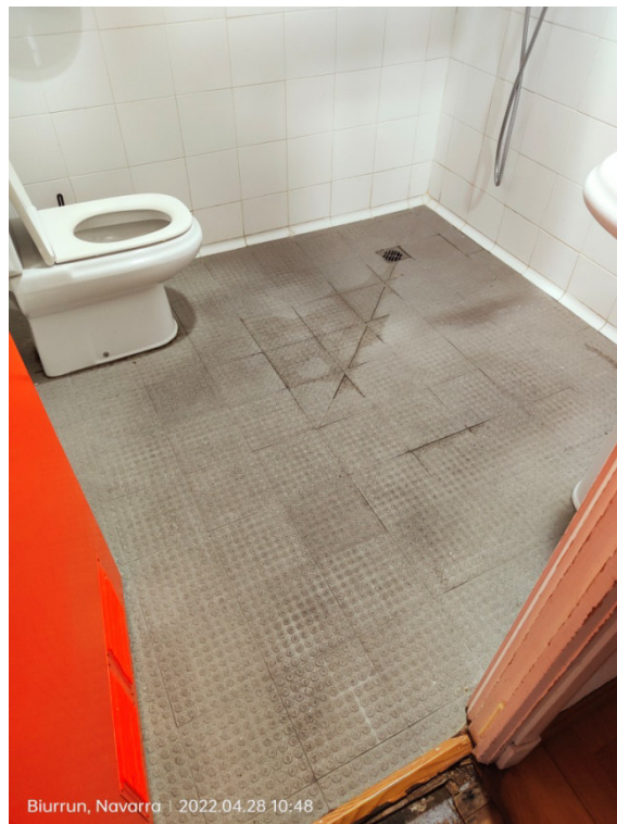
Suelo actual de baño de piso 1º Insalubre
