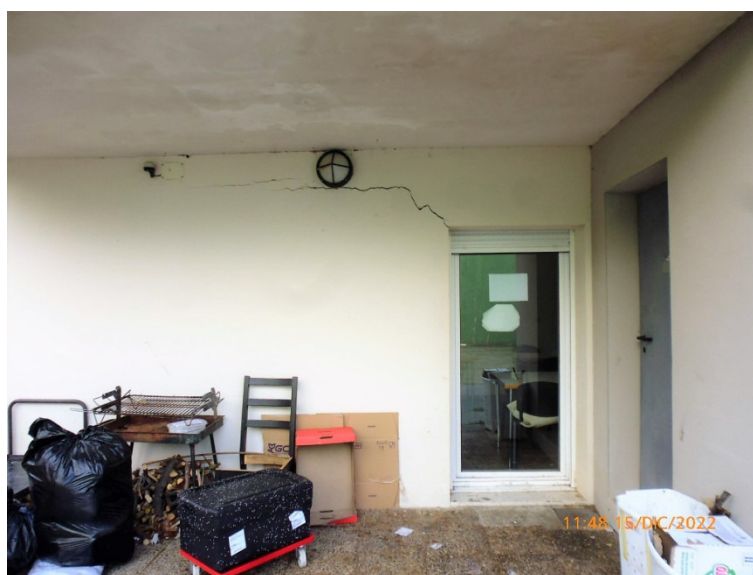
Grieta en fachada
