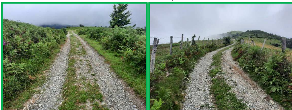
Tramos en mal estado
