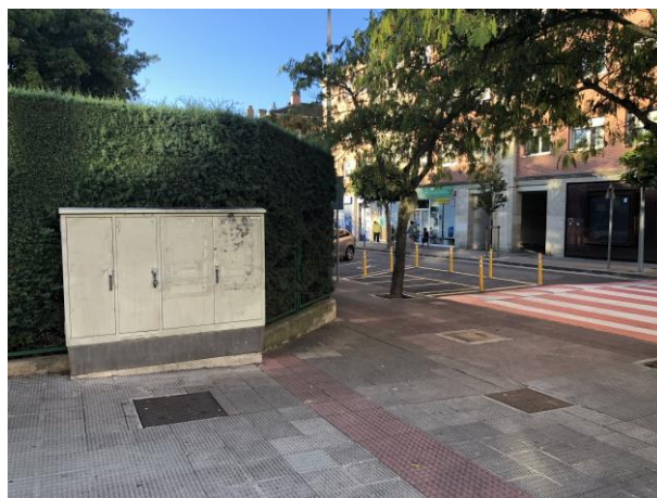
Cuadro de alumbrado CMU13
