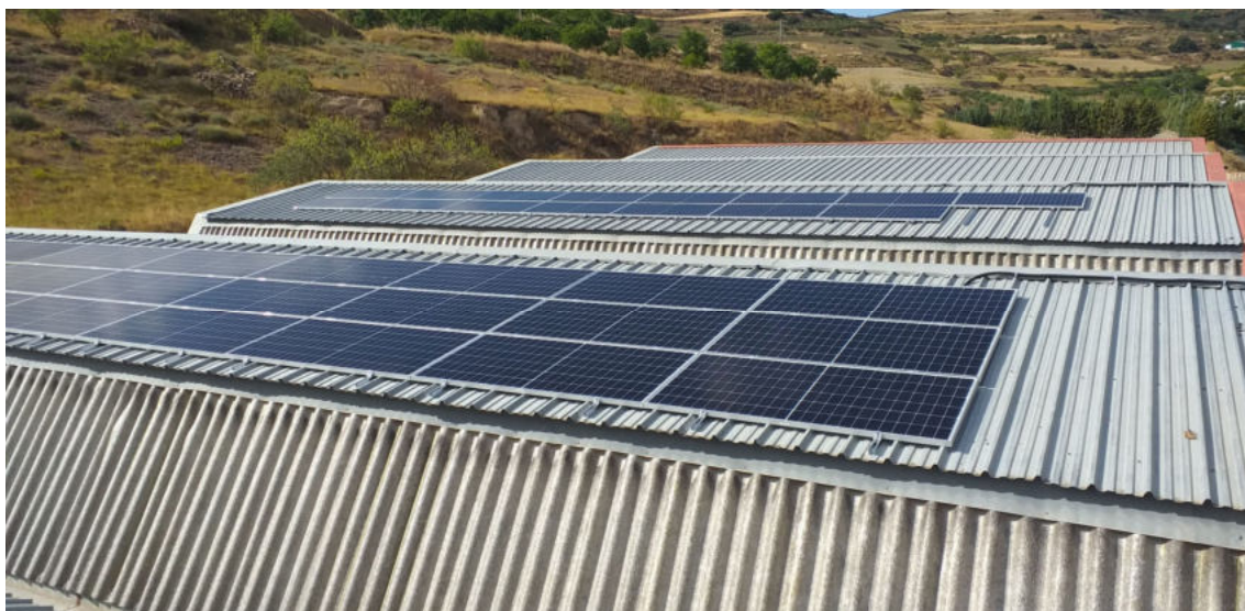
Instalación FV sobre cubierta metálica de manera coplanar a la misma
