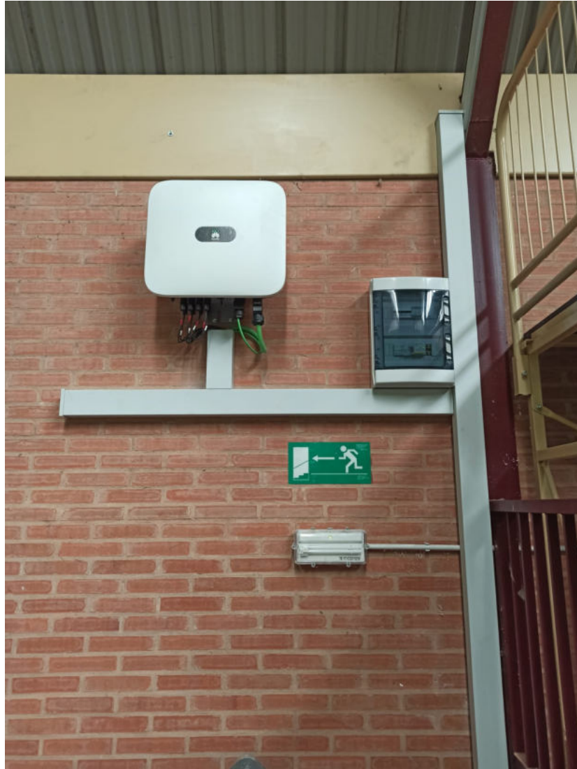
Inversor de la instalación de 20 kW existente
