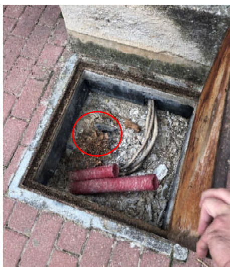
Arqueta #1# - Tubo PVC libre
