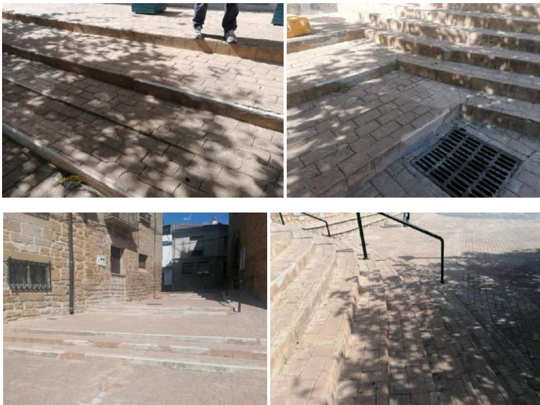
Diferentes muestras del estado del pavimento y de las escaleras existentes - Estado actual.
