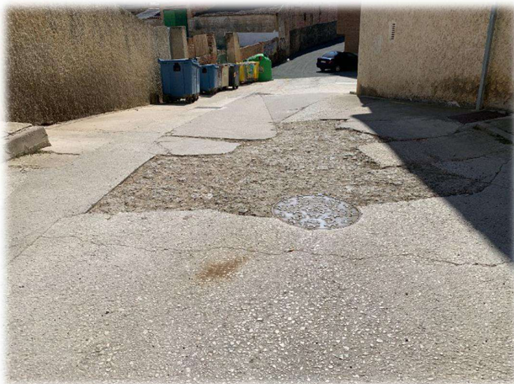
Fotografía 14 –Entronque calle La Bodega con la carretera de Lerín, arqueta de abastecimiento.
