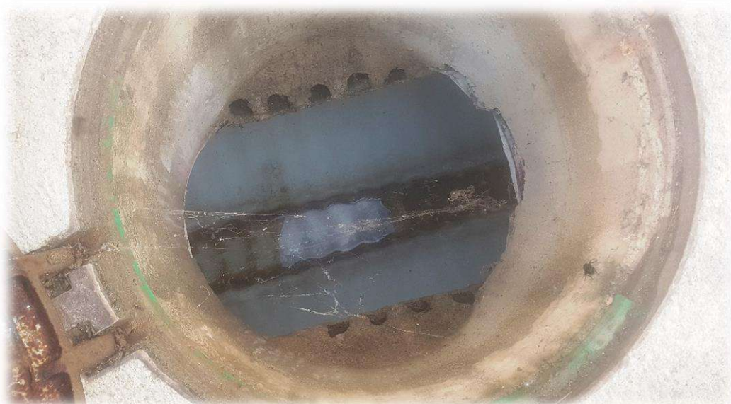
Fotografía 12 –Detalle pozo de pluviales en la Travesía de Lerín, red separativa
