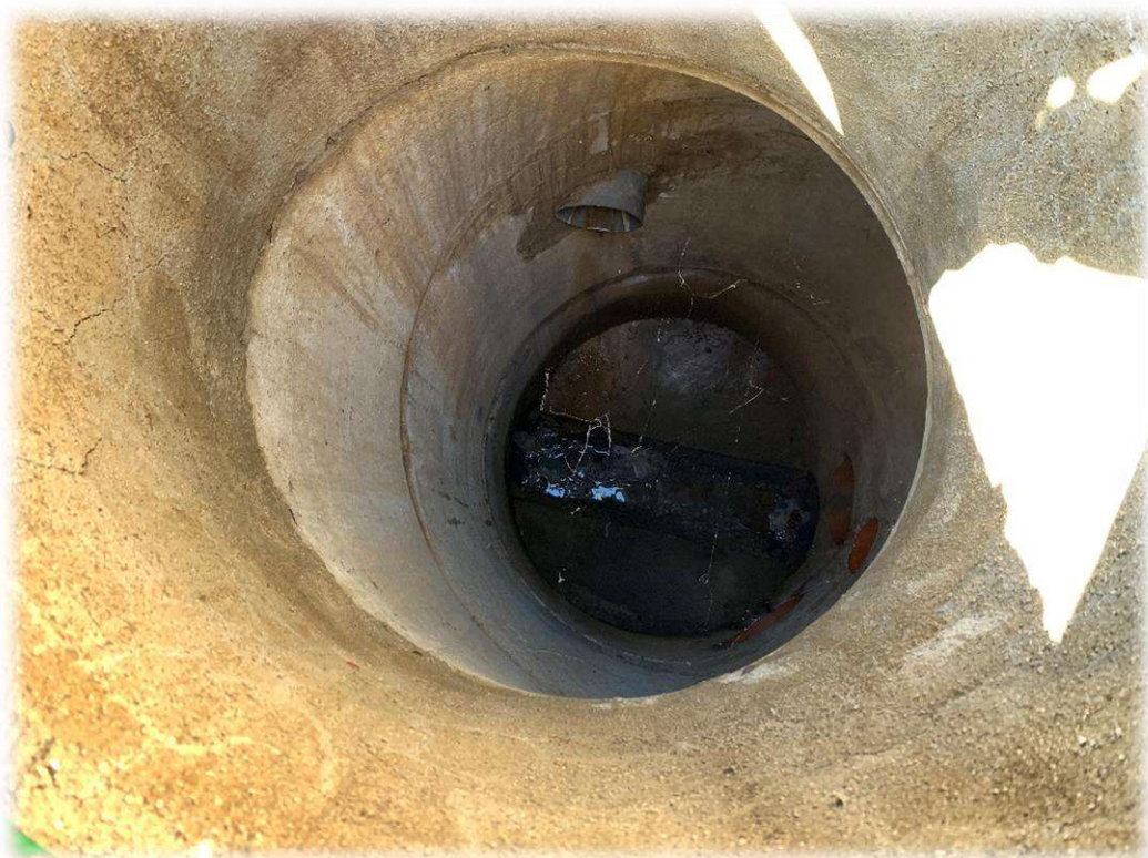
Fotografía 4 – Pozo de Saneamiento de la acometida del Hotel Villa de Larraga.
