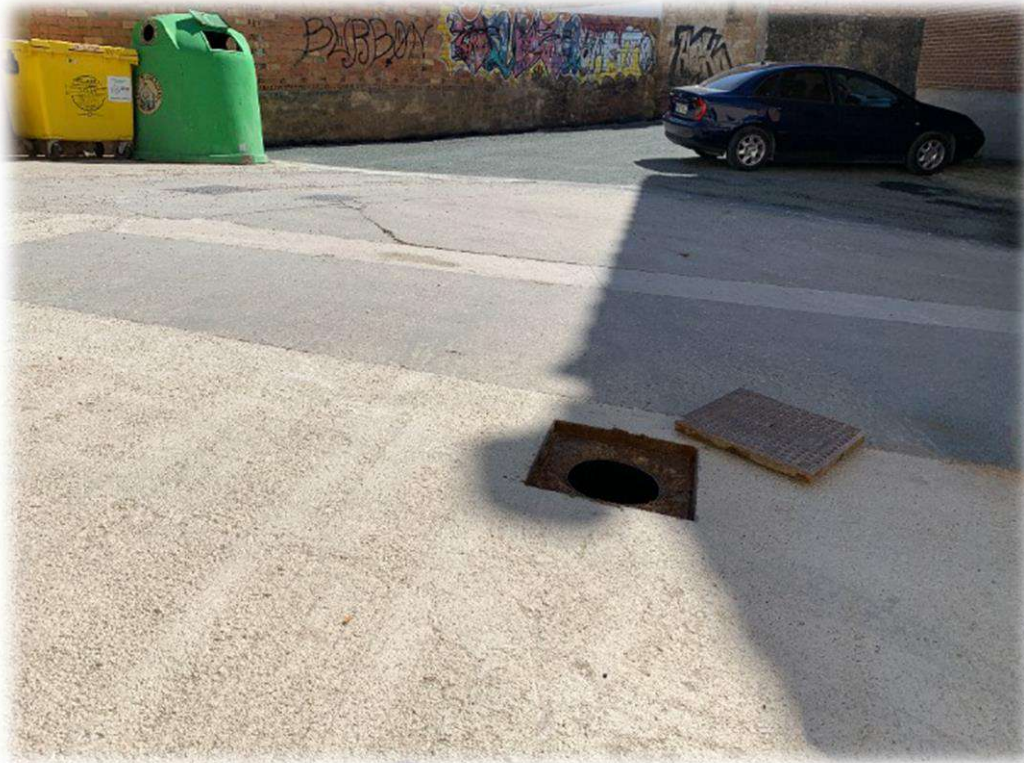
Fotografía 13 – Registros en los colectores de pluviales y fecales de 40x40 en el entronque de la calle La Bodega con Travesía de Lerín.
