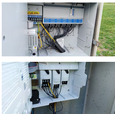
Fig.15: interior de los dos programadores, en la fotografía superior de la casa Hunter y en la inferior del fabricante RainBird. Solo en este ultimo, con un nuevo modulo de ampliación se podrían instalar todos los sectores nuevos, si no parte en uno y el resto en el otro programador.
