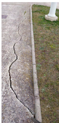
Fig.12: estado actual de la acera, se proyecta el paso de la nueva red por esta zona para poder reparar la ruptura del pavimento. En otras zonas de esta acera existen fracturas similares que durante el proceso de obra se podría también reparar.
