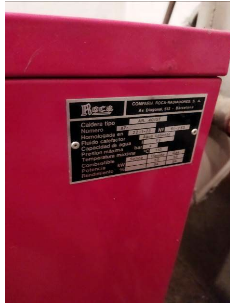
Foto nº 2: Placa caldera existente
