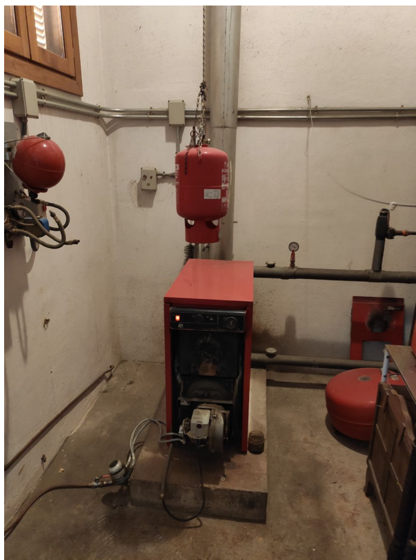
Fotografía de caldera y quemador
