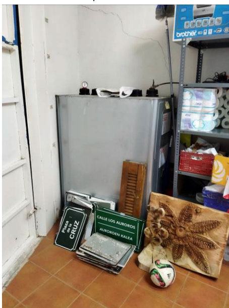
Foto nº 5: Depósito combustible existente
