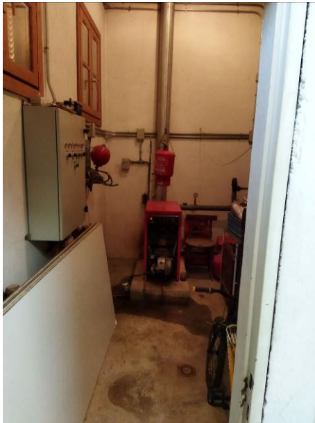
Foto nº 1: Vista general sala de calderas
