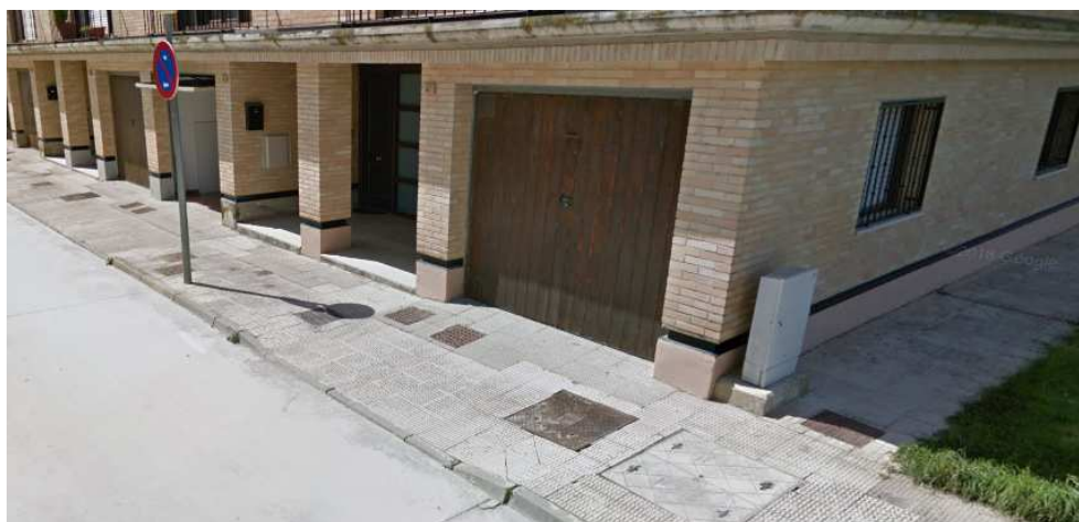
Cuadro y arqueta eléctrica y registro de telefonía.
