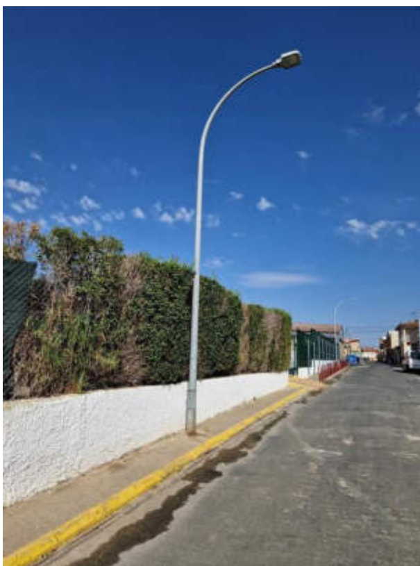
Detalle luminaria (Sin arqueta de acometida)
