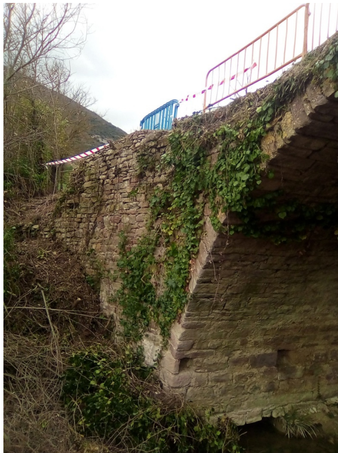
Estribo meridional aguas arriba, con mampuestos desprendidos y hiedra común
