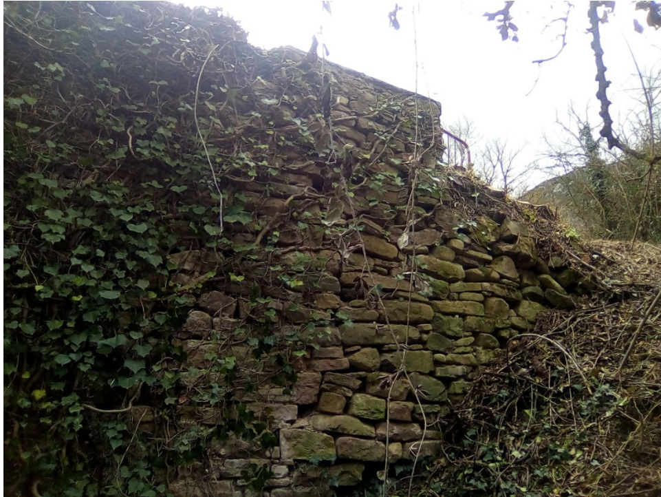
Estribo meridional aguas abajo, con mampuestos descalzados y desprendidos, a la vez que con numerosas raíces de hiedra común
