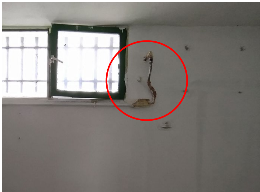
Fotografía 6: Antigua instalación de calentador de agua ubicado en almacén.
