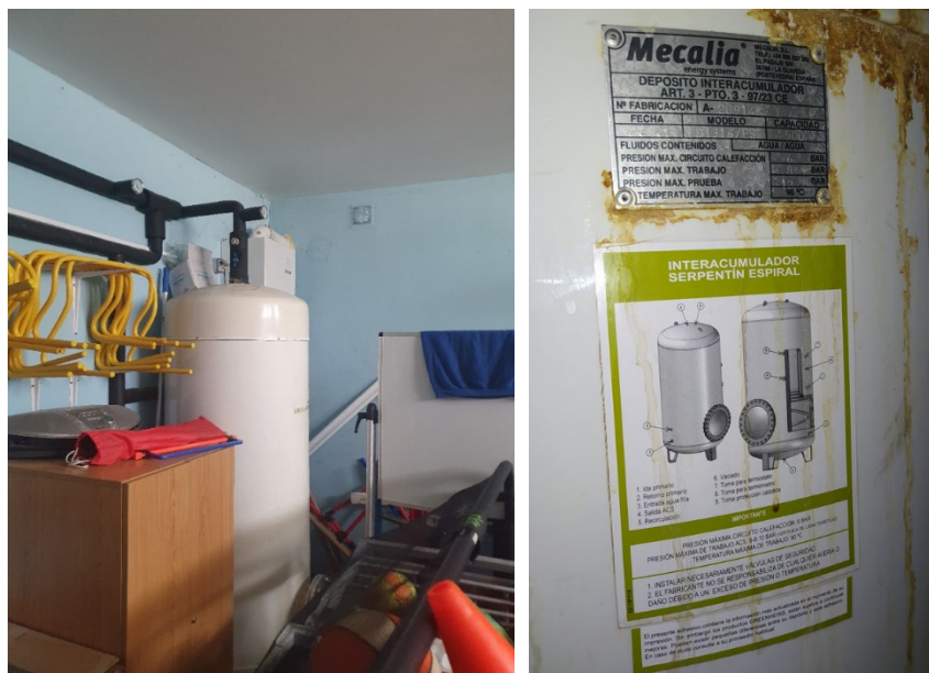
Fotografía 12: Productor de ACS ubicado en Despacho / Almacén
