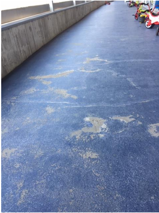
Estado del pavimento de la terraza exterior.
