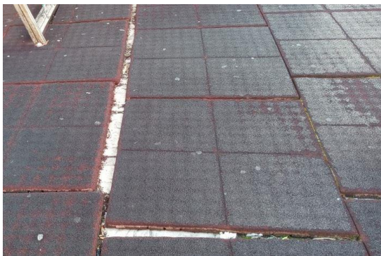
Estado del pavimento del patio.
