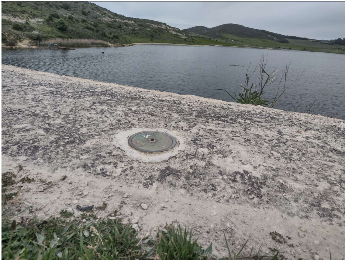
Imagen 2. Piezómetro instalado en el dique de Zolina.
