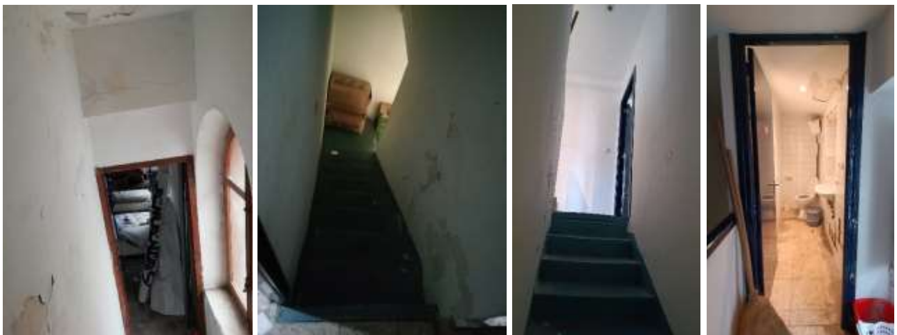
Escalera y aseo en planta primera. Son apreciables el estado de deterioro y las humedades que afectan al edificio.
