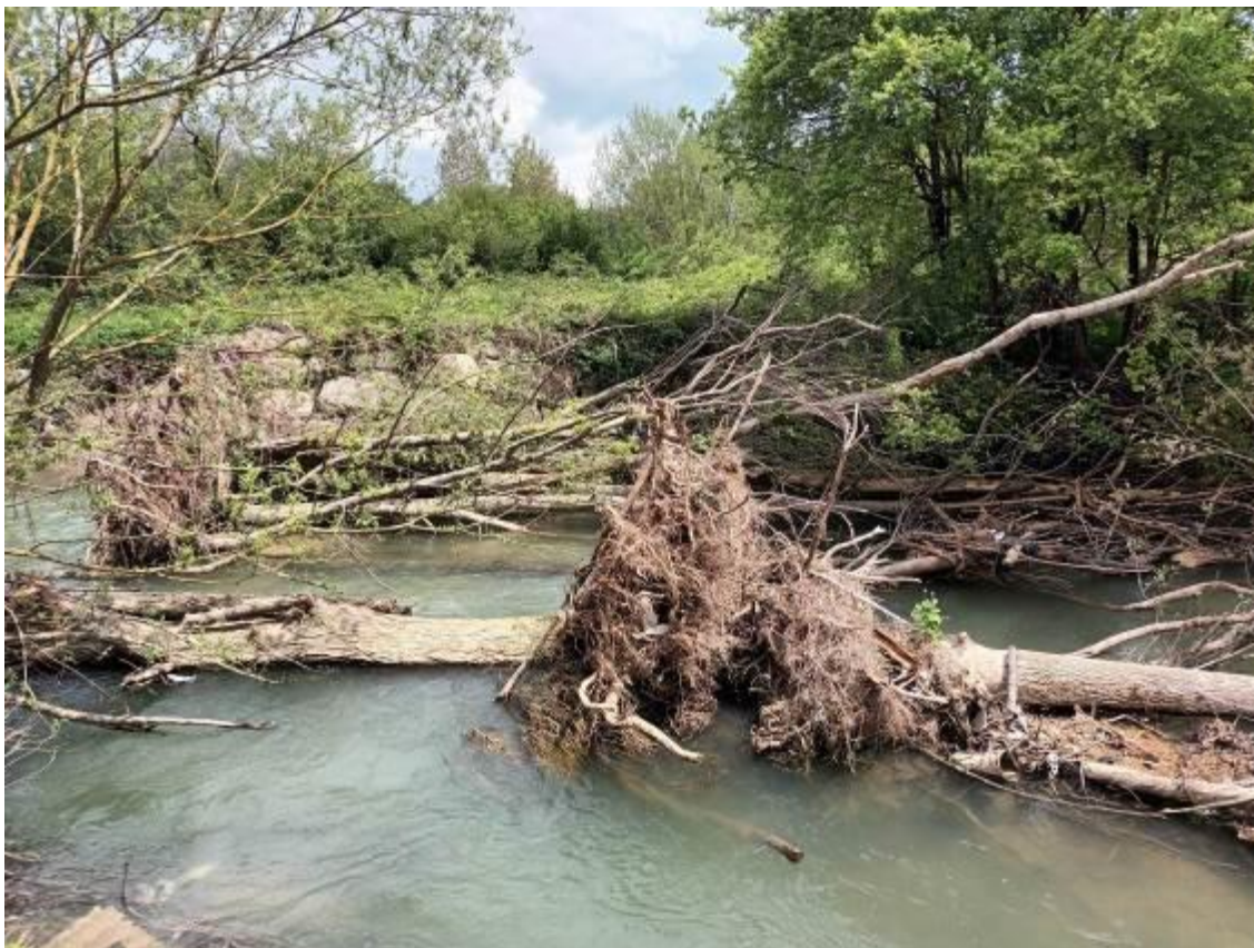
Zona afectada por la fuerza del río, con la caída de árboles y la afección sobre una escollera existente.
