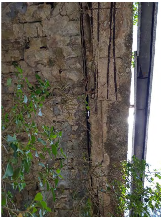
Deterioros observados desde el cauce, en puente del río Udarbe
