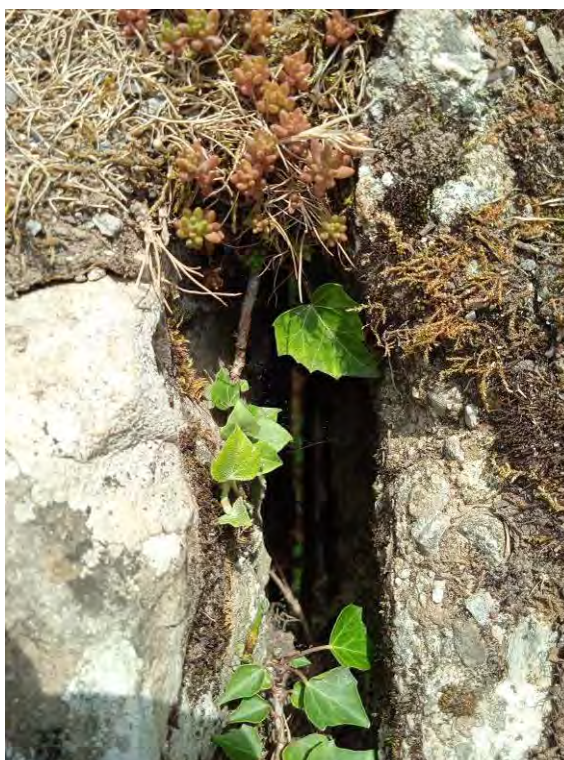
Deterioros del puente, observados en coronación, en el río Udarbe
