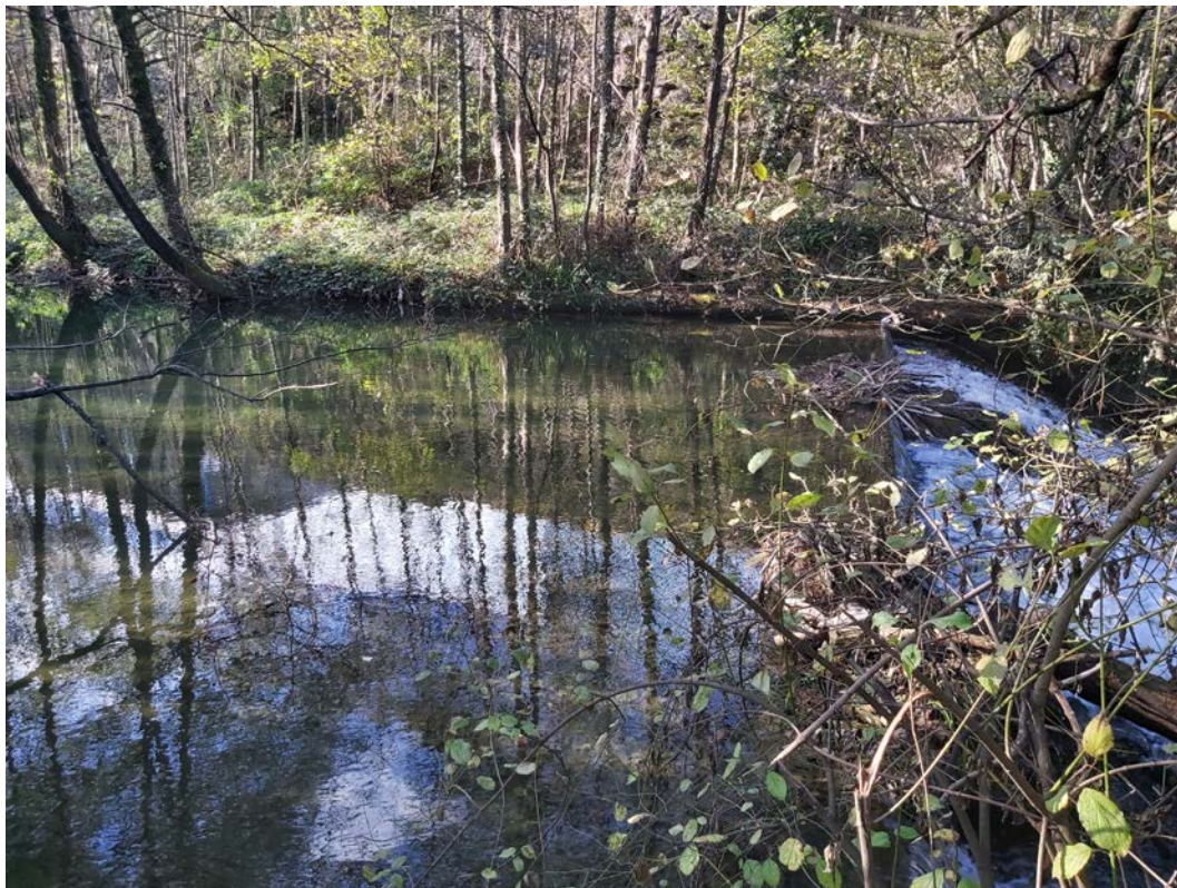
Trasdós de Presa Colmatado
