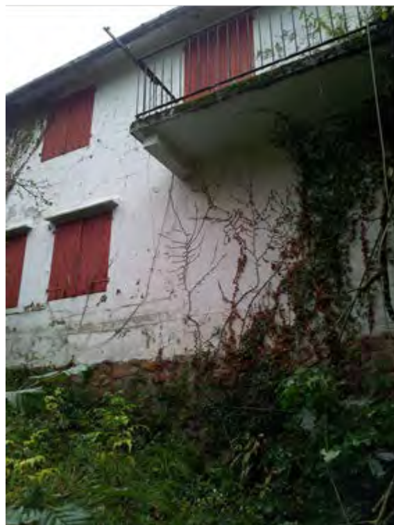
Vivienda a demoler
