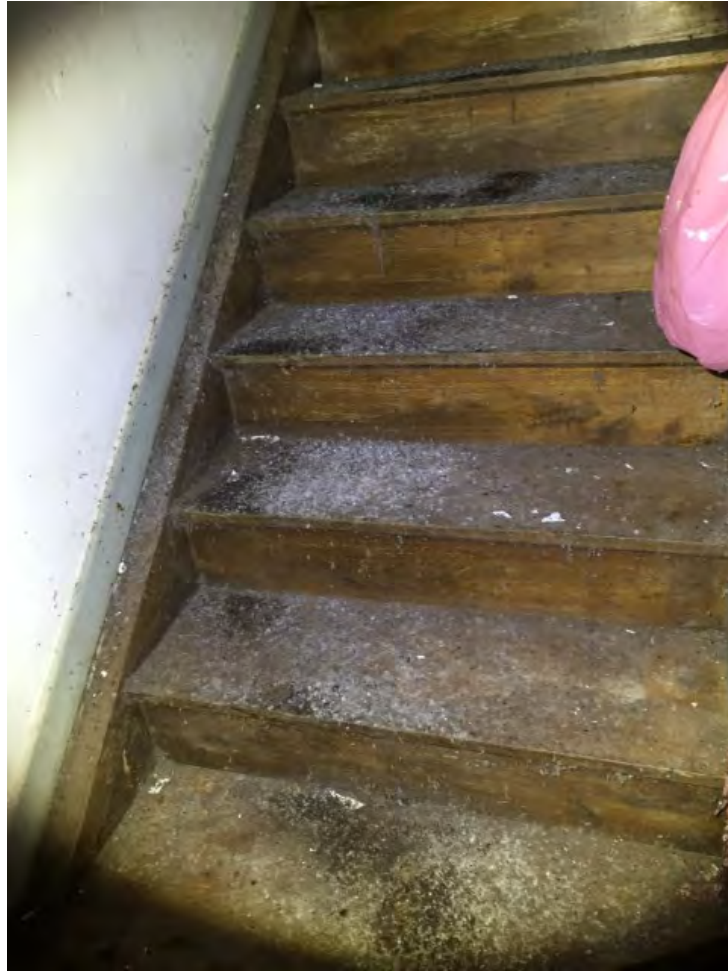
Escaleras con las manchas de guano de los murciélagos.
