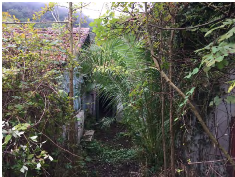
Edificios de la central hidráulica, en estado ruinoso y parcialmente invadidos por la vegetación.
