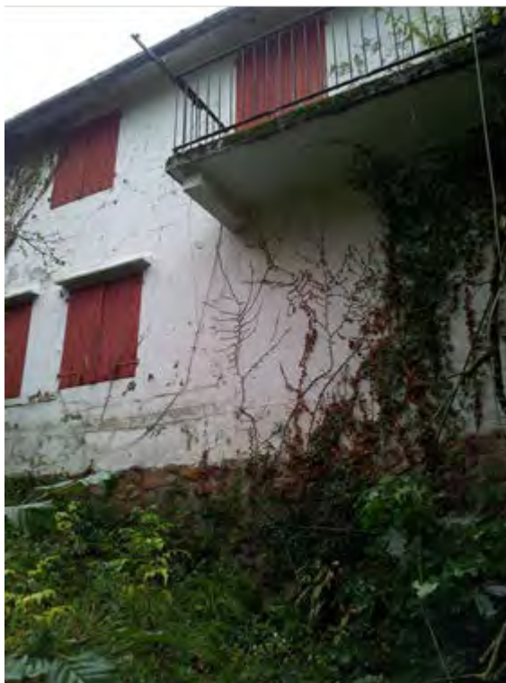
Vivienda a demoler
