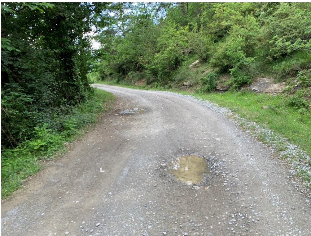
FOTOGRAFÍA 5: Detalle de baches en el camino.
