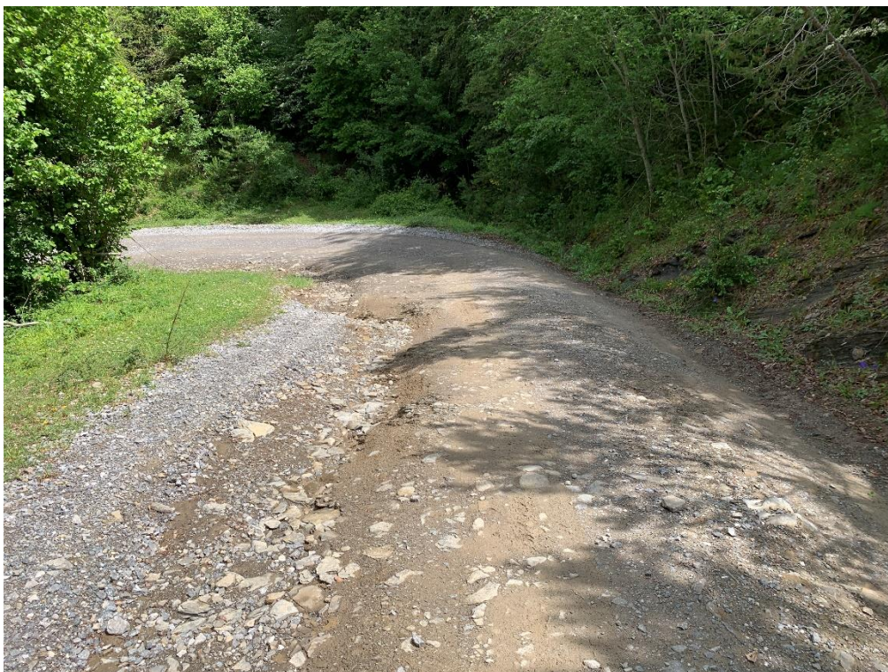
FOTOGRAFÍA 9: Vista del mal estado del camino.
