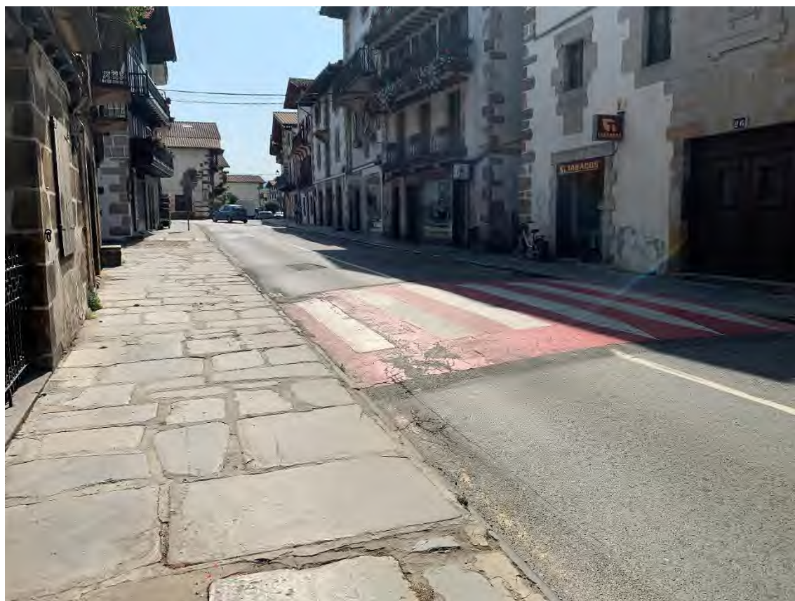
FOTOGRAFÍA 19: Paso peatonal sobreelevado, con bordillo muy deteriorado a ambos lados y un mal enrase, además de no estar señalizado ni en pavimento ni en calzada.
