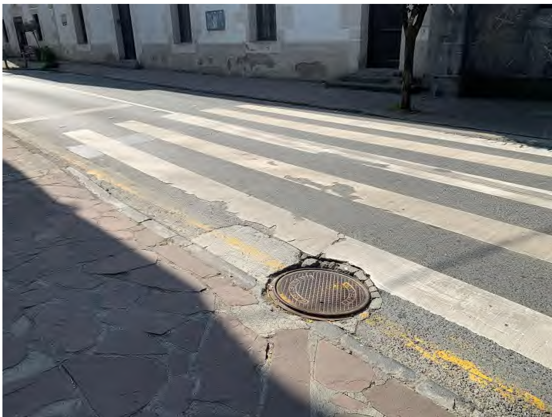
FOTOGRAFÍA 10: Aceras de dimensiones amplias al otro lado, con paso semirebajado y tapa de registro hundida, en la acera de en frente sucede lo mismo con un sumidero y la calzada. Estado del pavimento regular.
