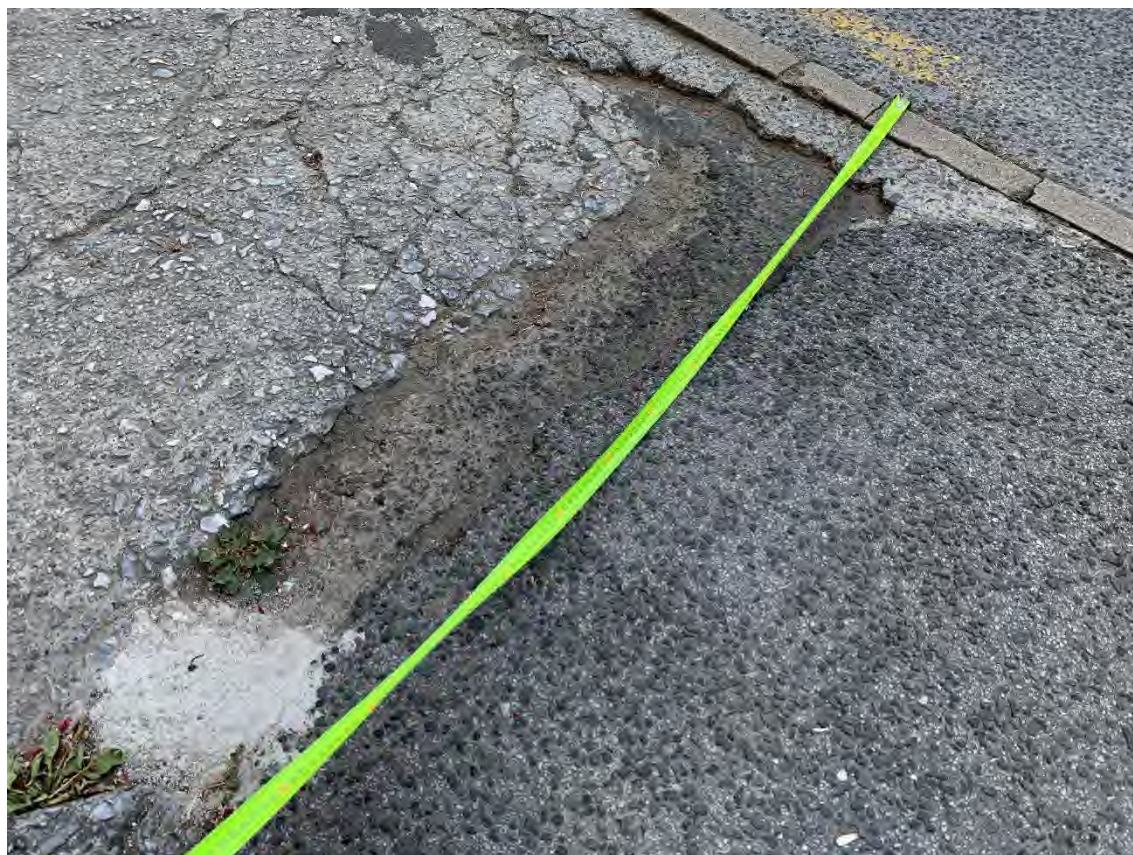
FOTOGRAFÍA 6: Estado del pavimento entre los portales 27 a 29 de Eztegara.
