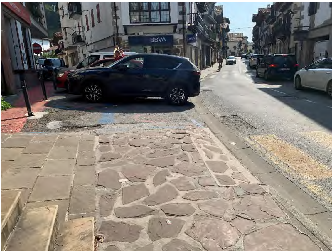
FOTOGRAFÍA 14: Desaparición de la acera frente al portal 15 de Alzate, hay un paso que no reúne ninguna condición para considerarlo accesible.
