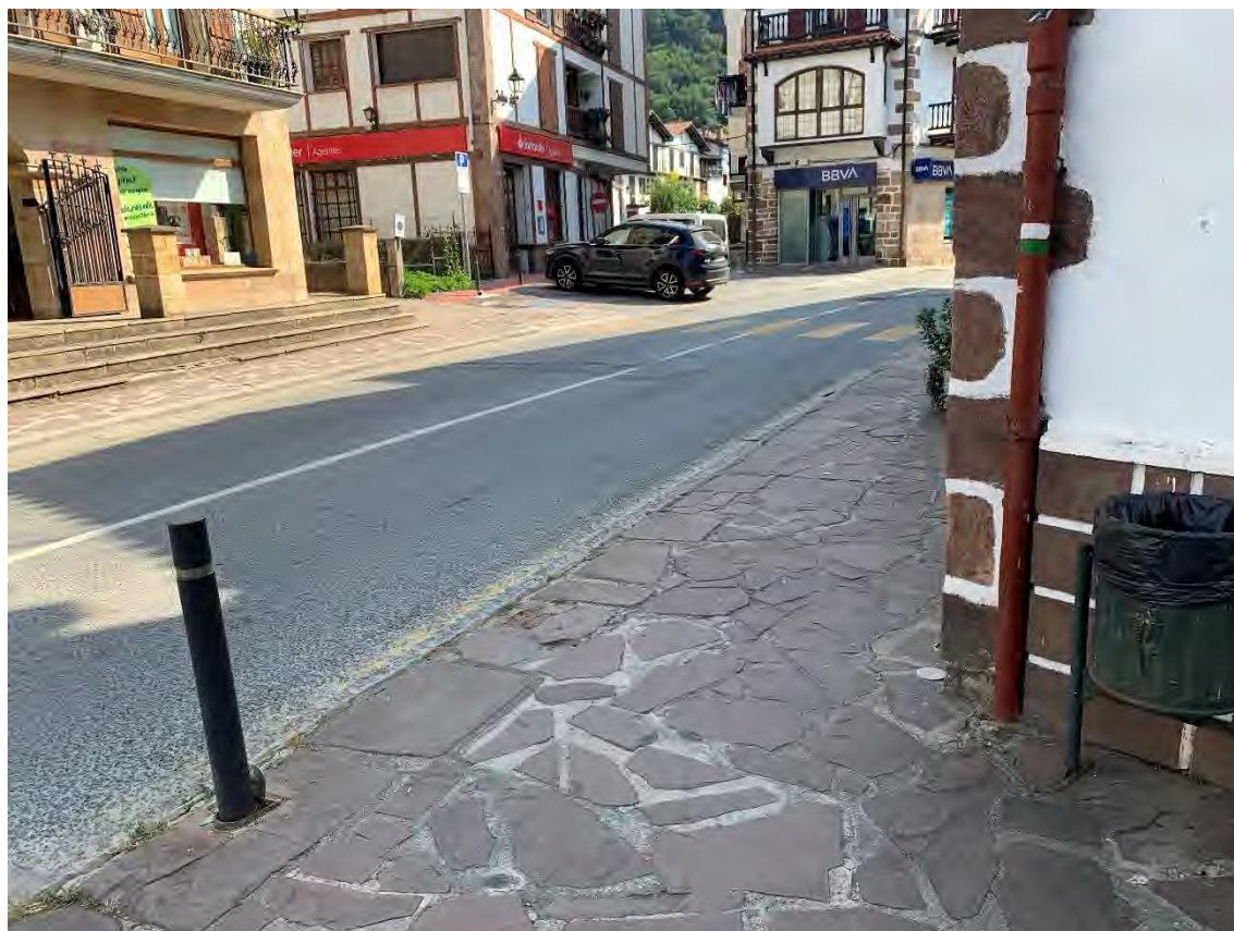
FOTOGRAFÍA 16: Estrechamiento sin señalizar en la esquina del portal 16. Pavimento irregular en mal estado.
