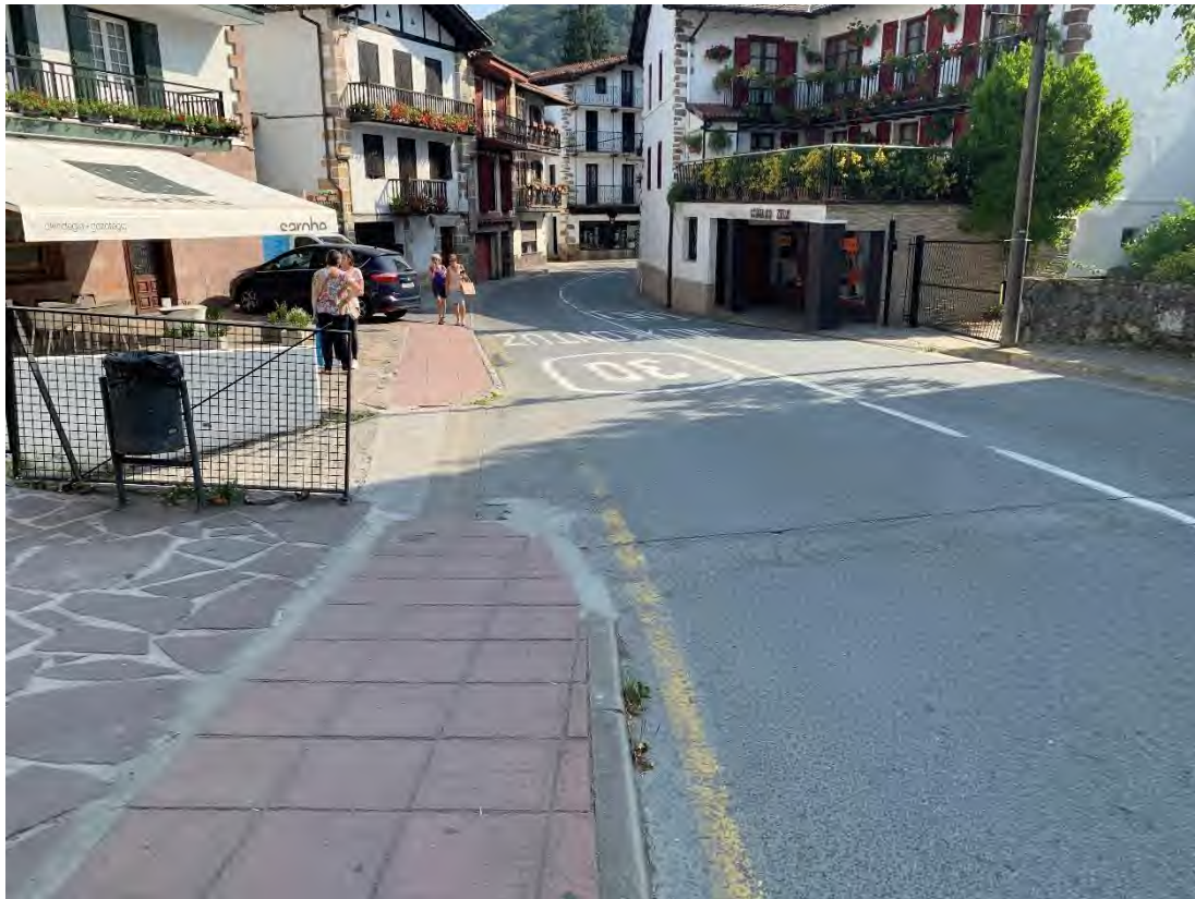
FOTOGRAFÍA 2: Discontinuidad de aceras en Eztegarra, portales 23 a 25, con pavimento inadecuado y falta de anchura. Al fondo se ve la desaparición de la acera al llegar a la curva, margen derecha.
