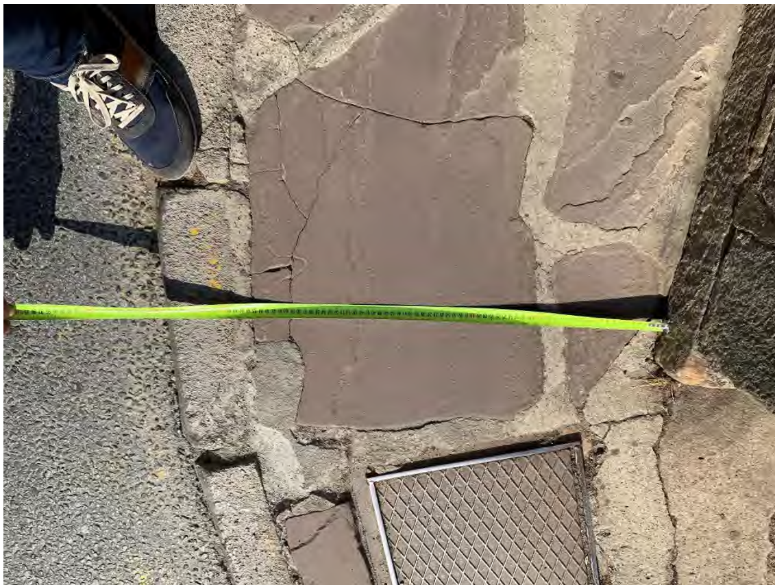
FOTOGRAFÍA 13: Otro estrechamiento de la acera, un poco más adelante, con tapa sobreelevada de la rasante para facilitar el tropiezo y caída de los peatones.
