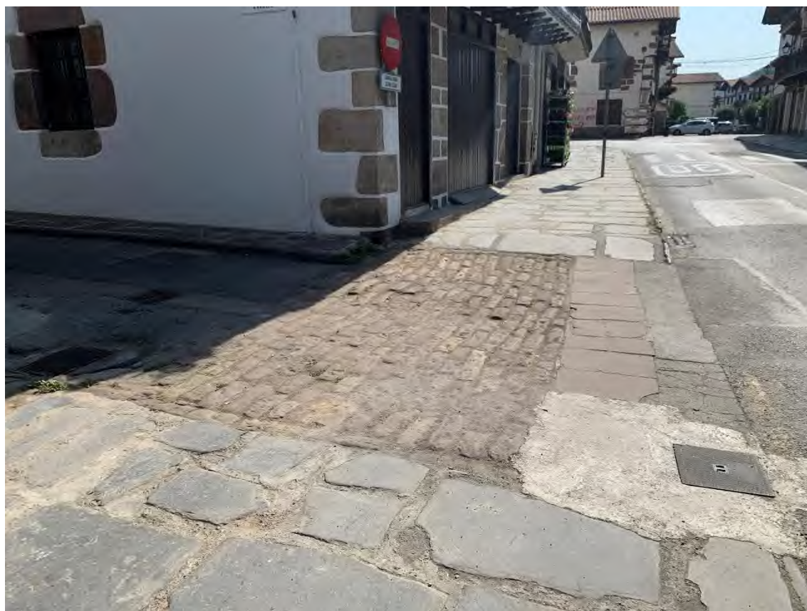
FOTOGRAFÍA 20: Pavimento en mal estado con reparaciones por fugas de acometidas.
