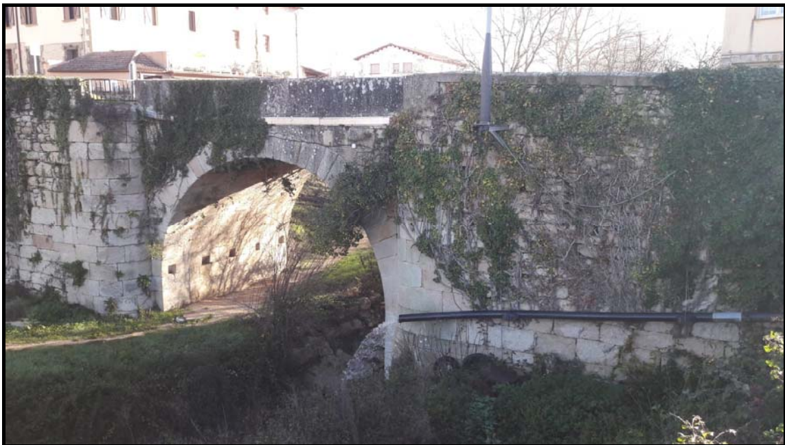
VISTA DEL PUENTE AGUAS ARRIBA, SITUACIÓN ACERA VOLADA
