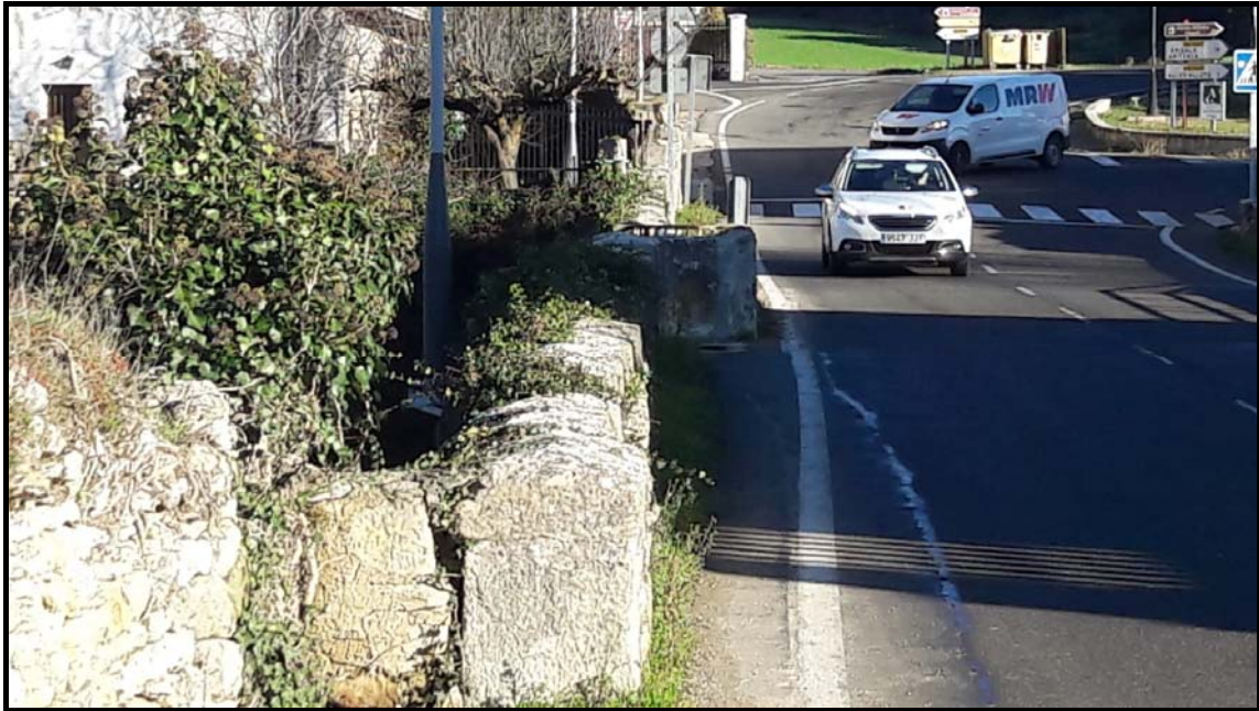
DETALLE PELIGROSO ESTRECHAMIENTO EN CUNETA Y PRETIL
