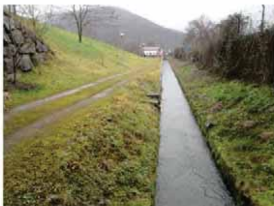
Canal de alimentación
