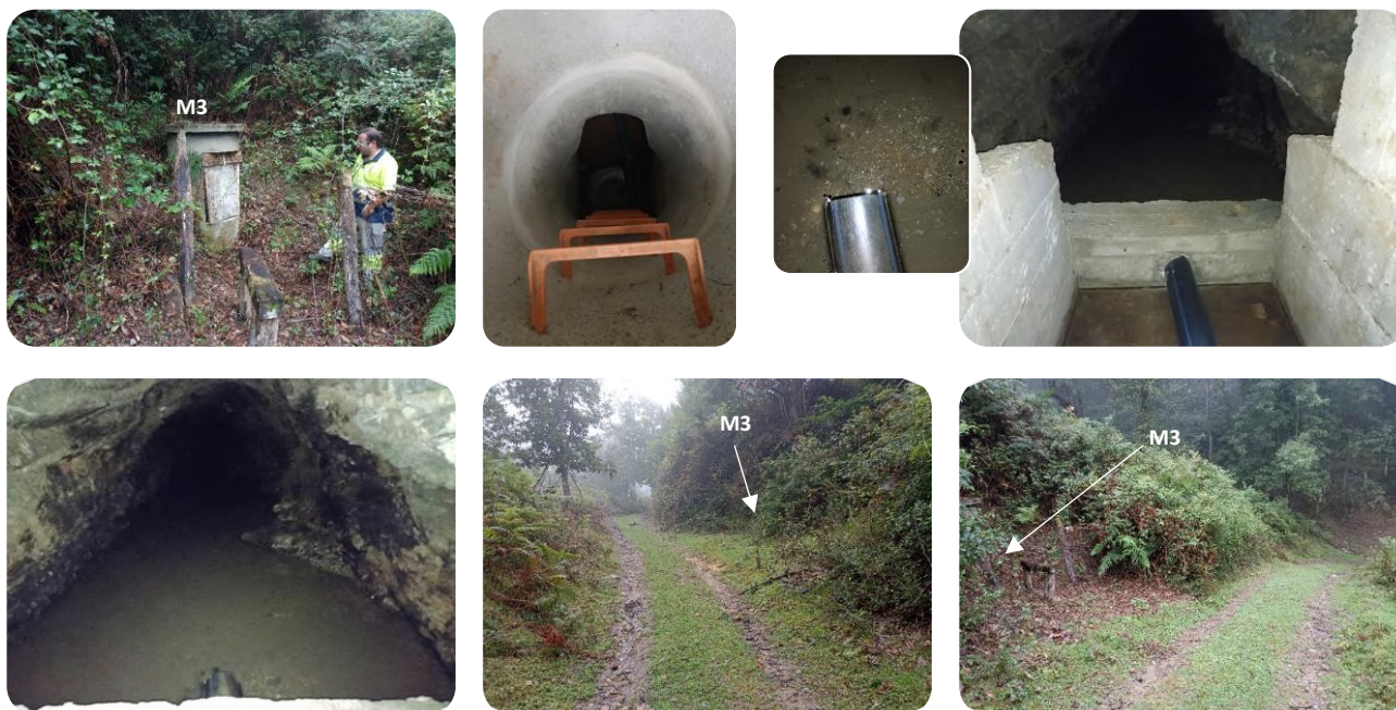
F13 Fotografías de la caseta de captación de M3 y pista de acceso tierras desde camino hormigonada (Domíñapizko Bidea).
