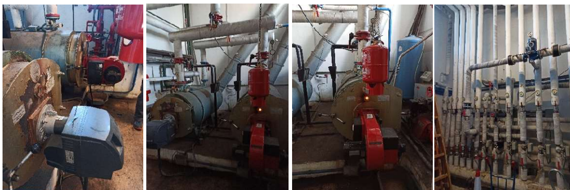
Sala de calderas
