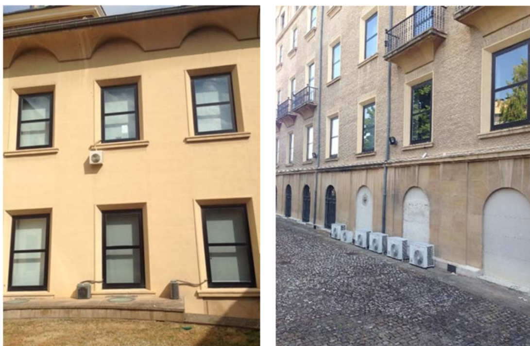
Fig.5. Imágenes de la ubicación de las unidades exteriores de aire acondicionado, de oficinas (izqda.) y del salón de actos (dcha.)
