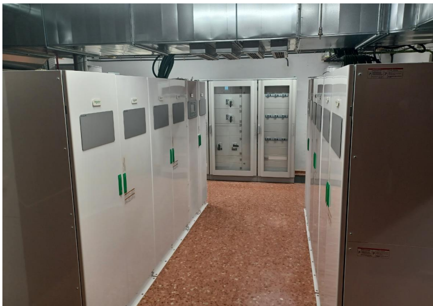
Figura 16: Sala de cuadros SAI y baterías actual.
