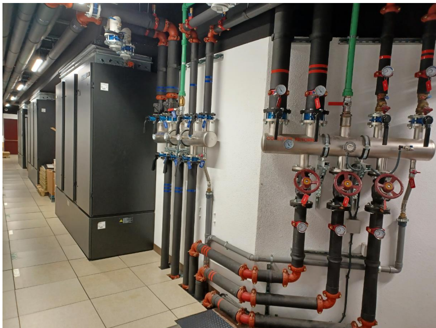
Figura 22: Colectores de distribución y CRAHs del CPD
