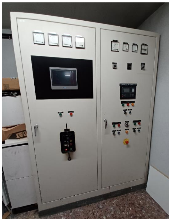
Figura 13: Cuadro de control del grupo electrógeno
