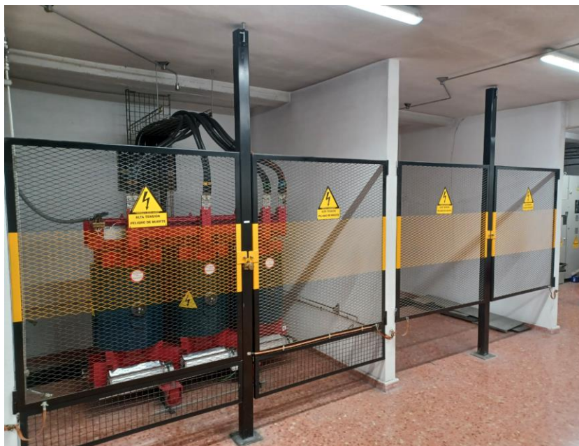
Figura 6: Transformador existente y espacio disponible
