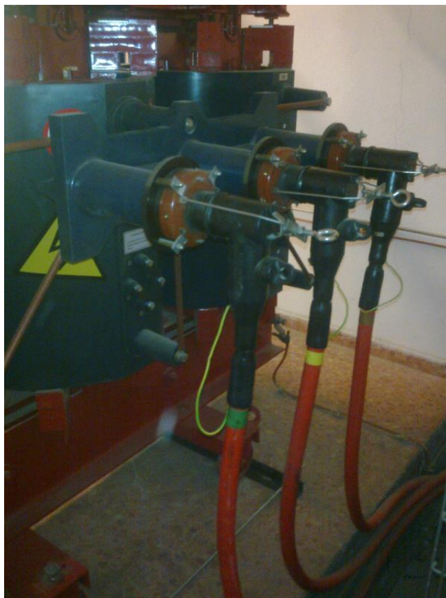
Figura 9: Transformador existente (parte trasera)
