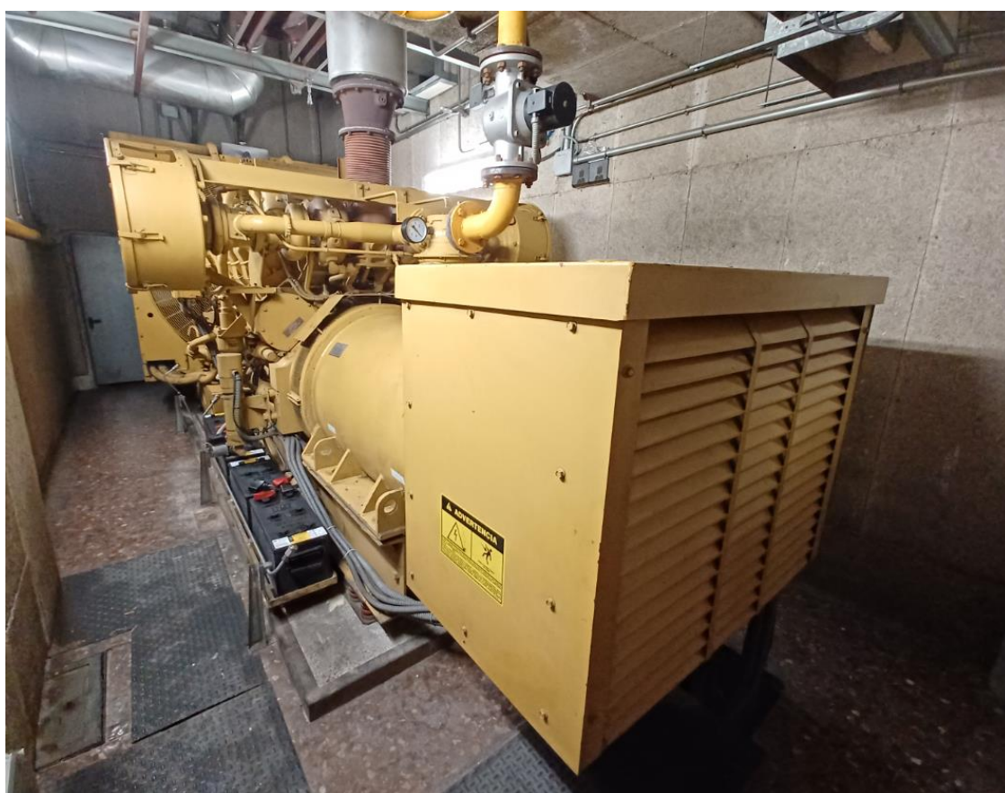
Figura 11: Grupo electrógeno existente
