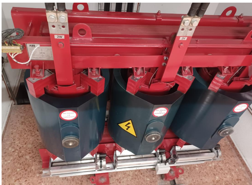
Figura 8: Transformador existente y barra de ventilación
