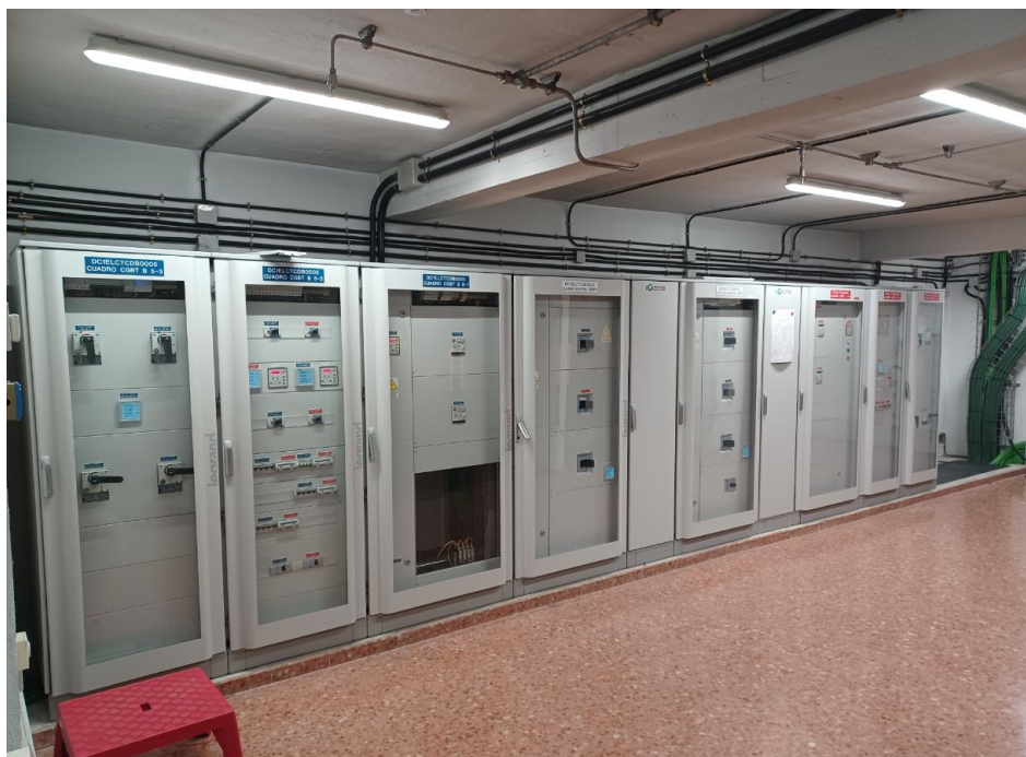
Figura 14: Cuadro General de Baja Tensión actual.
