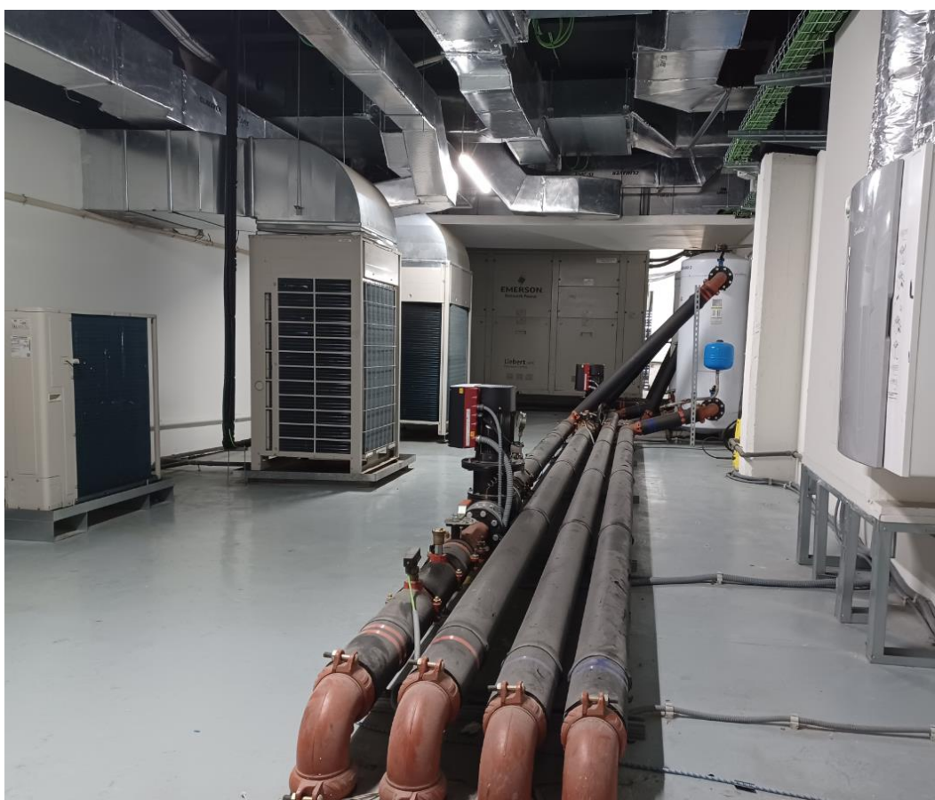
Figura 18: Sala Técnica de Climatización actual.
