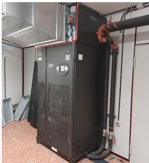
Figura 24: CRAH Liebert PH046 para la sala de SAI
