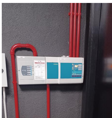
Figura 26: Centrales de aspiración precoz existentes en el CPD
