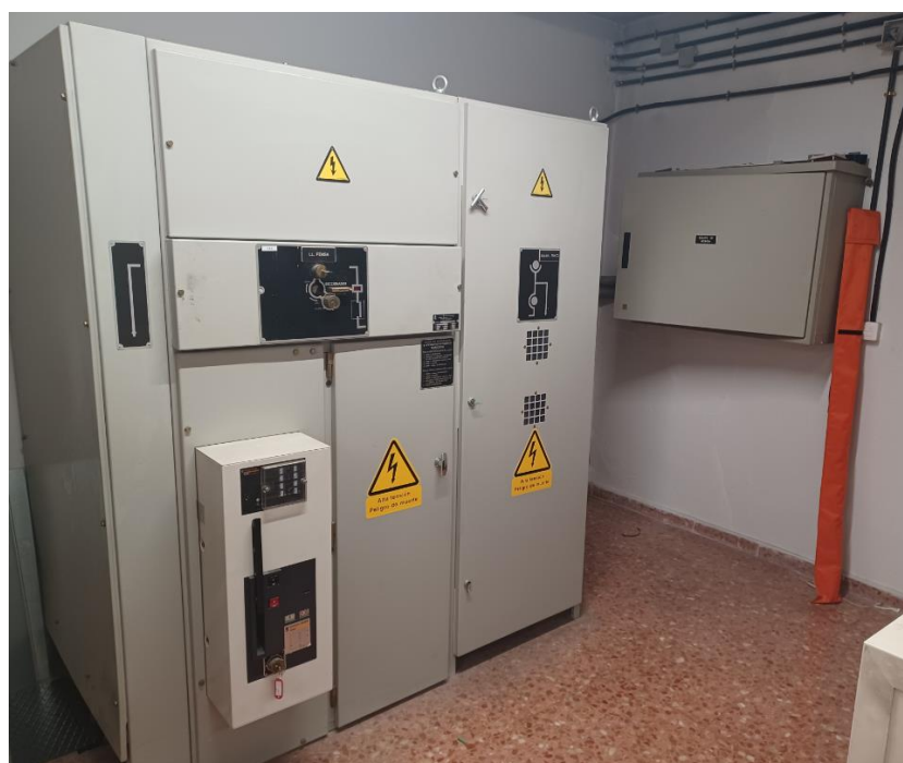
Figura 7: Celdas de protección y medida en alta tensión actuales.
