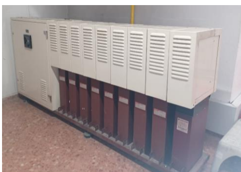
Figura 15: Batería de condensadores
