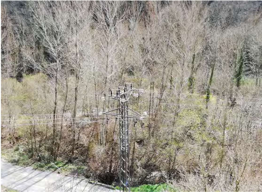
Apoyo nº : 0 Entronque con línea Iberdrola.
